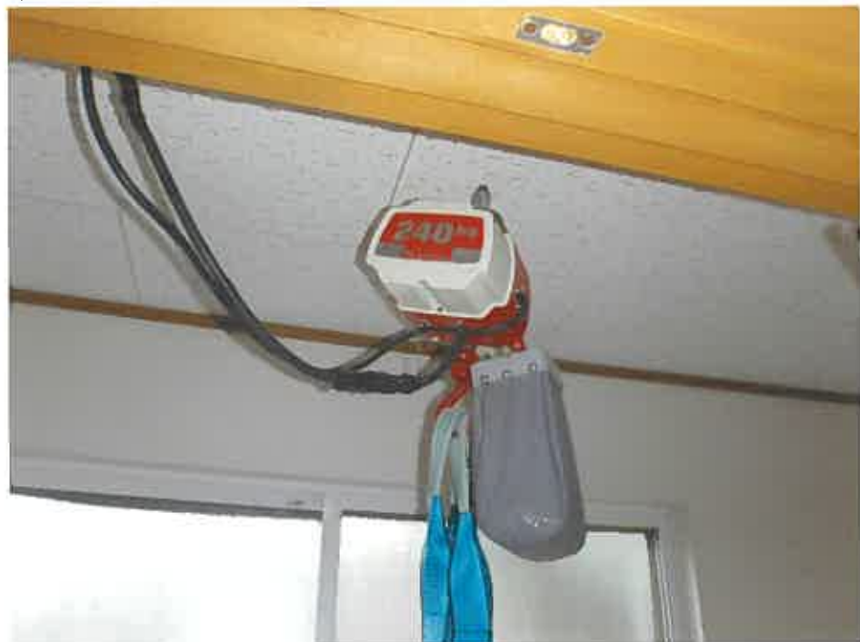
物件10 2階洋室南西側に設置されているクレーン
