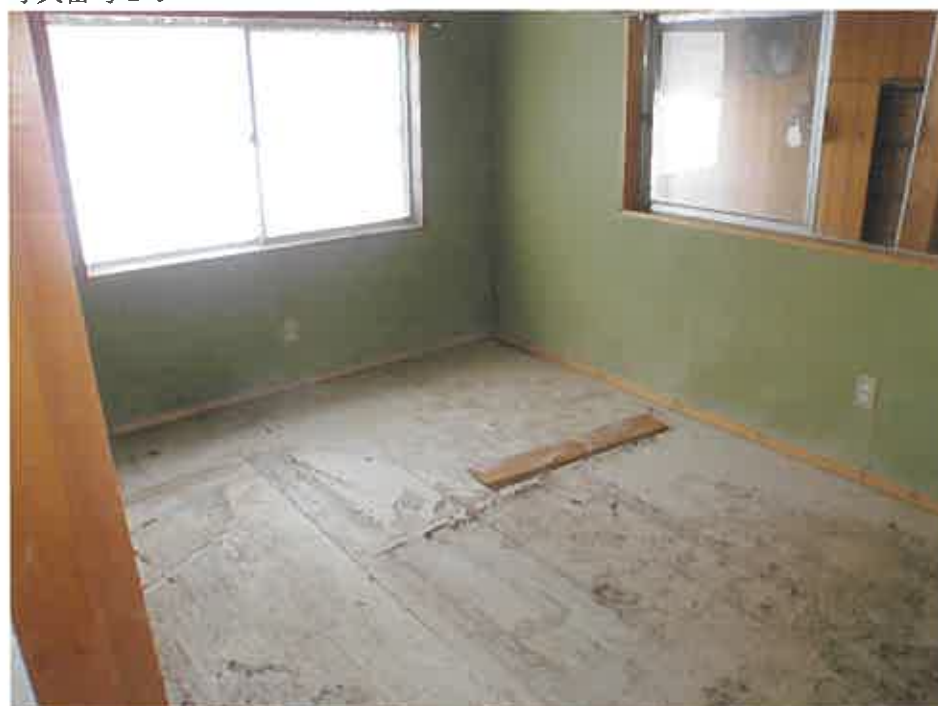
物件2 1階和室 ※水害の影響で床がきしんでいる。
