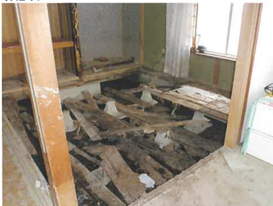
物件2 1階和室(8帖) ※床が落ちている
