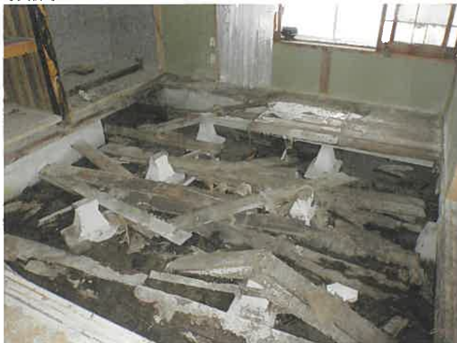
物件2 1階和室(6帖) ※床が落ちている
