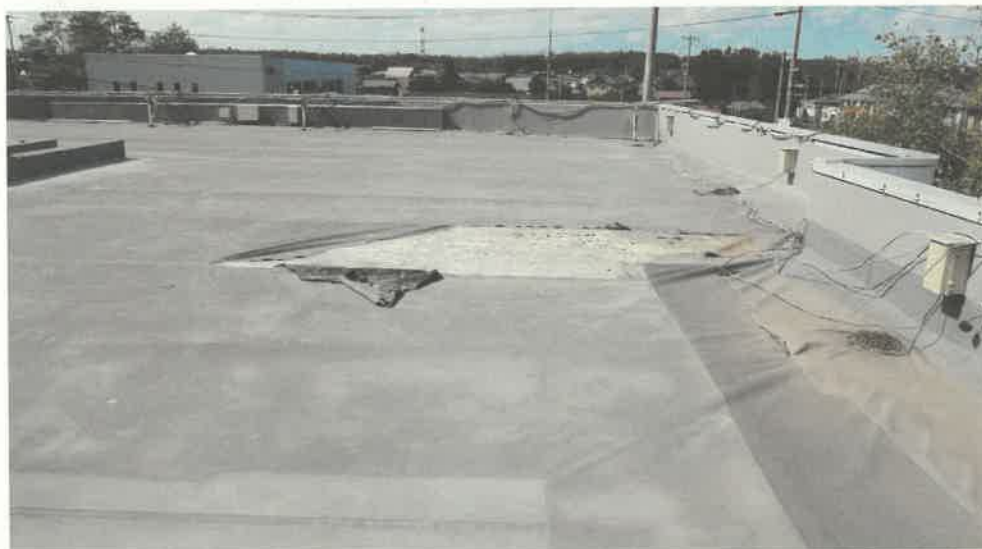
前同（防水シートの破損状況）
