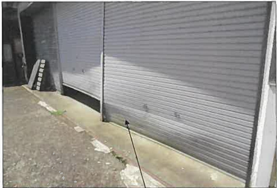
シャッターの破損 ( 8 枚目)
