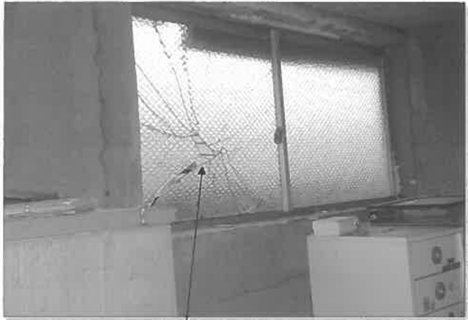
窓ガラスが割れている。
