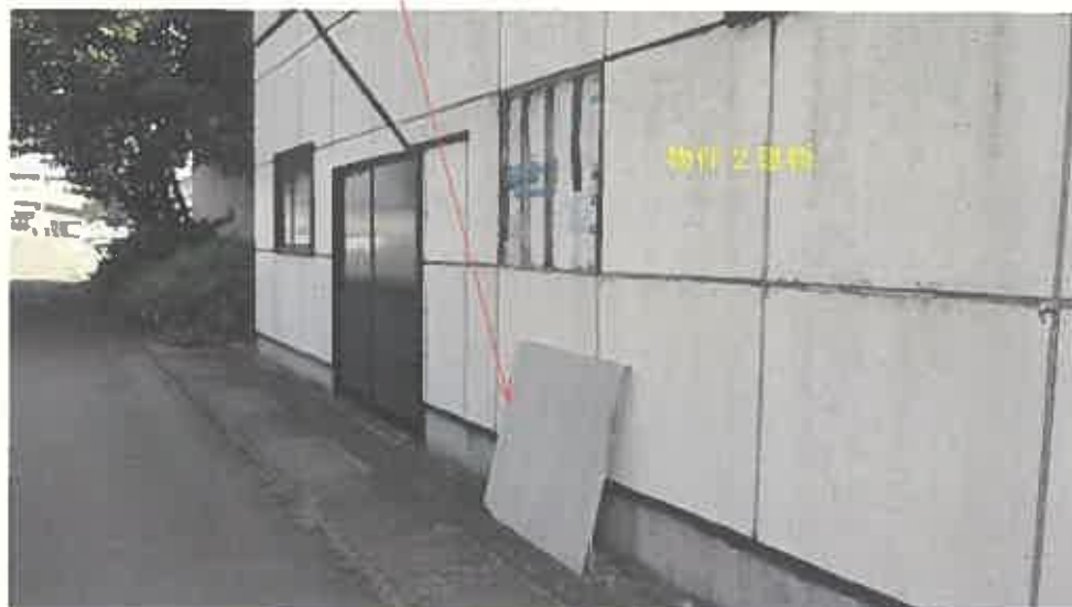
窓枠が外れている
