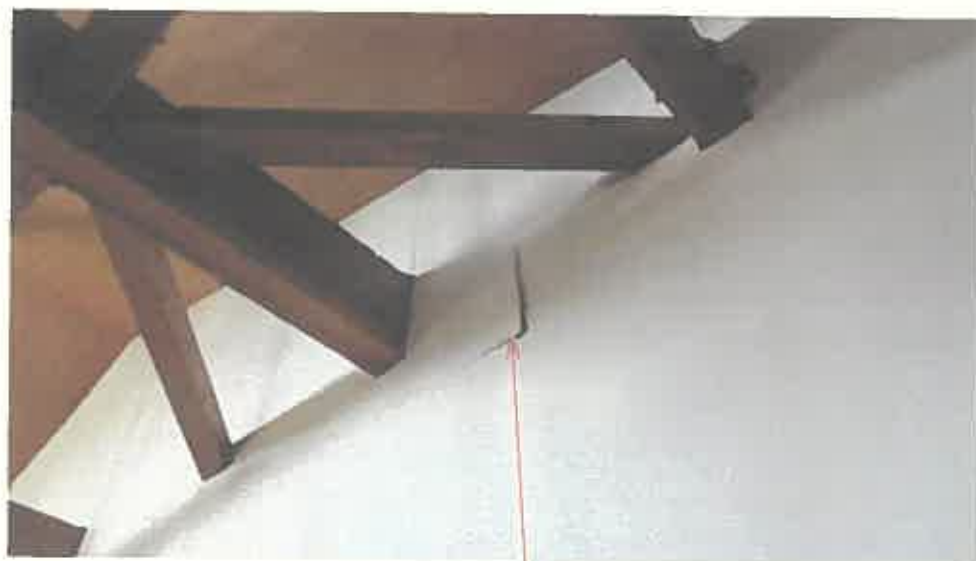
前同 (内壁の亀裂)
