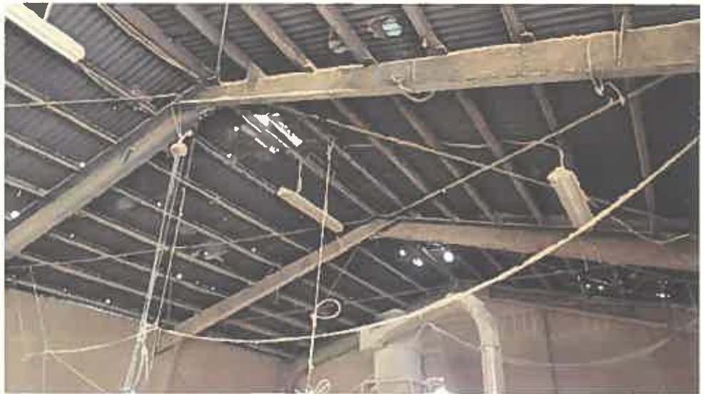
前同 (屋根の腐食穴多数)
