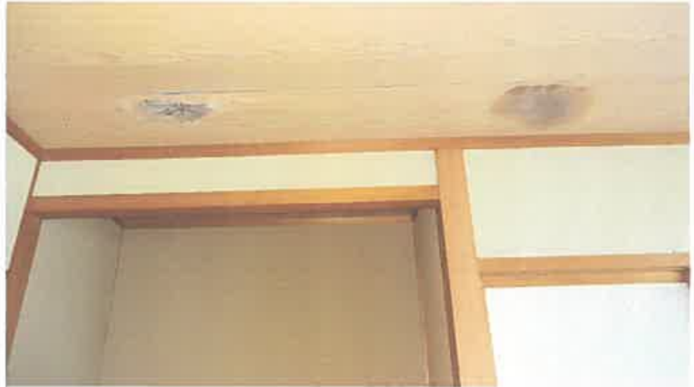
前同 (天井の雨漏り跡)
