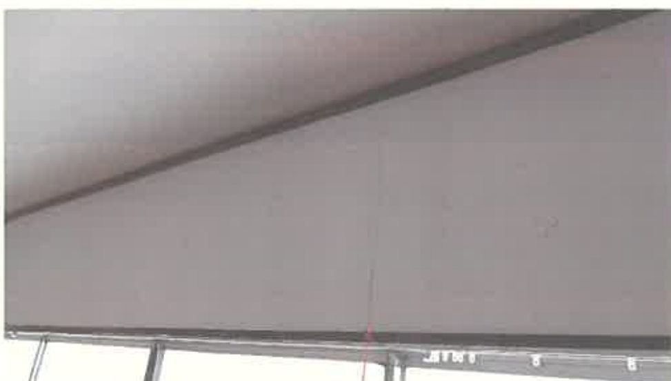
前同（クロスの亀裂）
