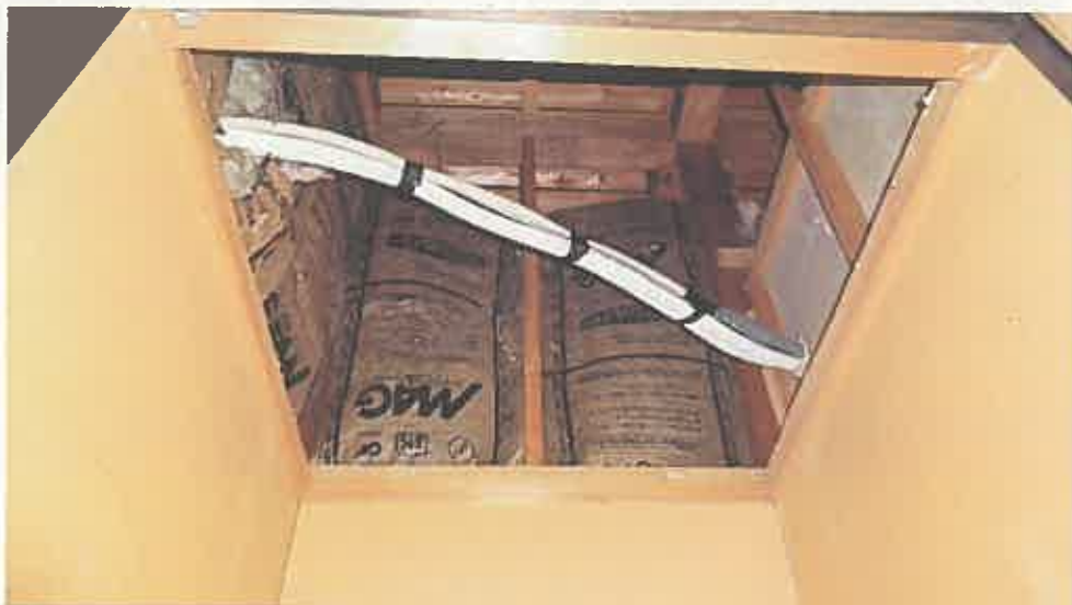
前同（収納の天井が抜け落ちている）
