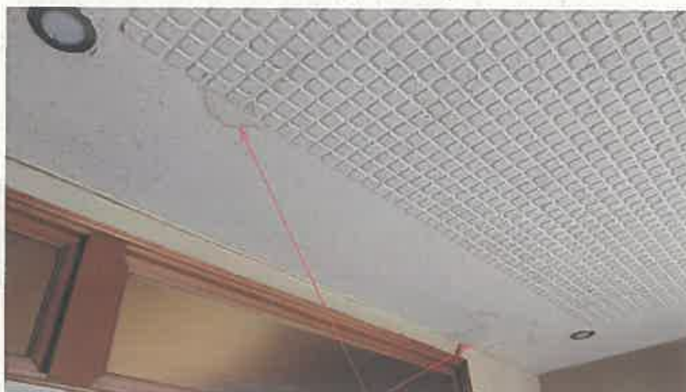
前同（天井の滲み）
