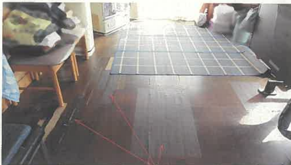
前同（床の損傷）
