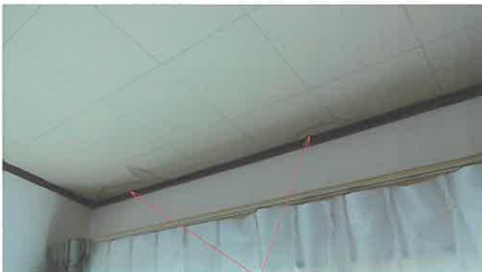
前同（2階浴室の水漏れによるしみ）
