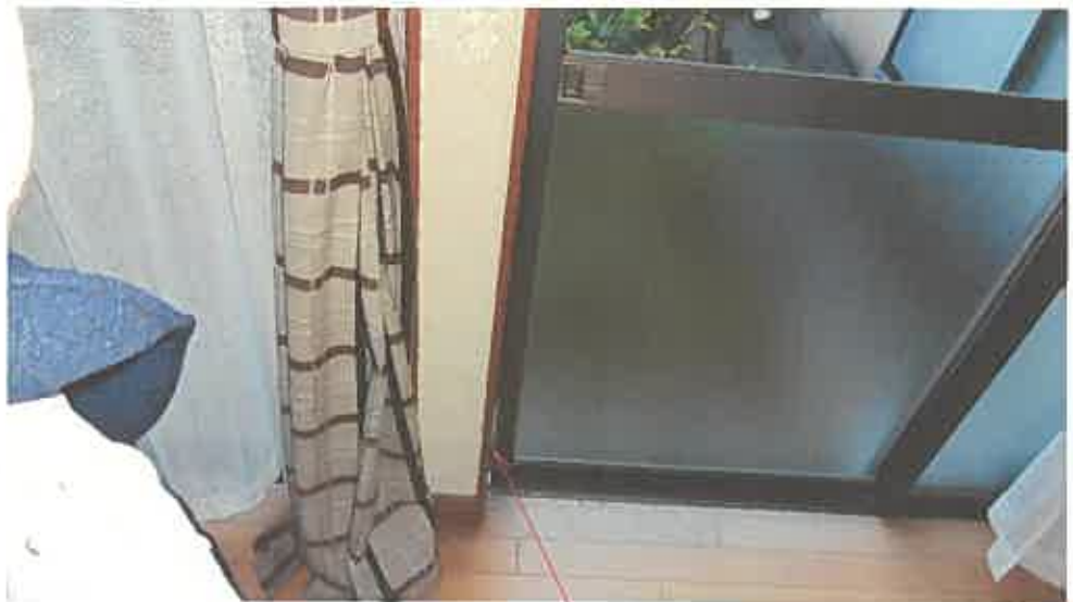
前同（建具の隙間）
