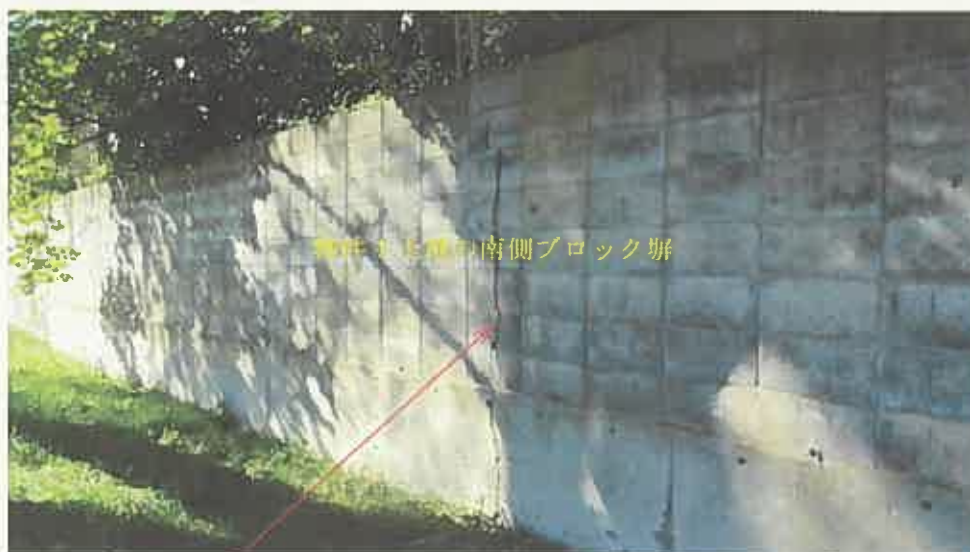
亀裂が生じている
