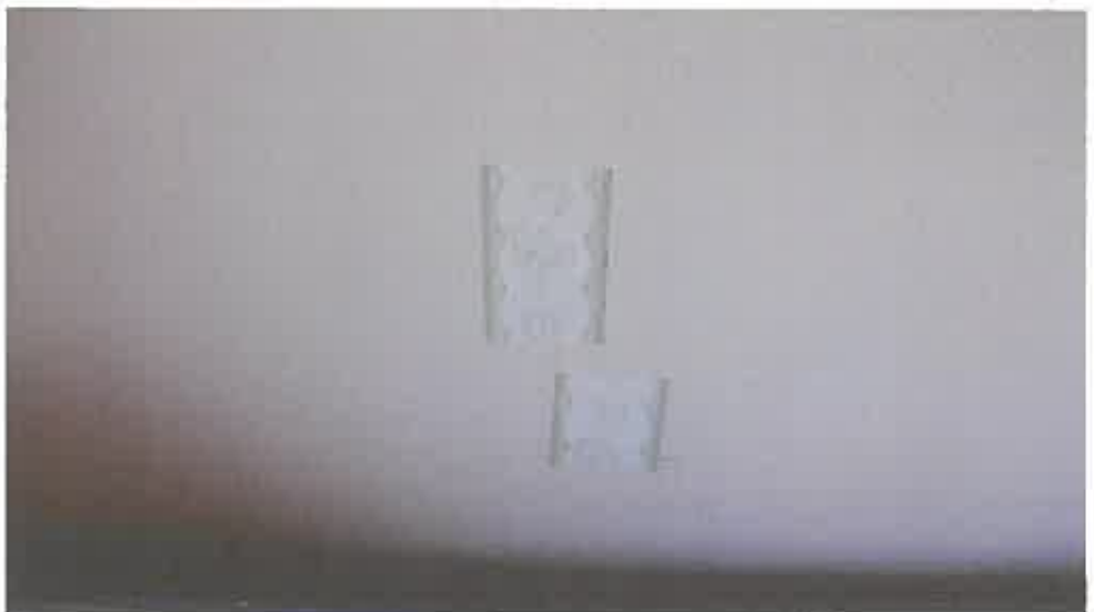
前同 (壁穴の補修跡)
