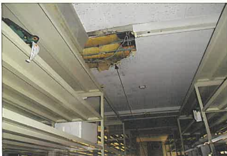
雨漏りによる損傷
