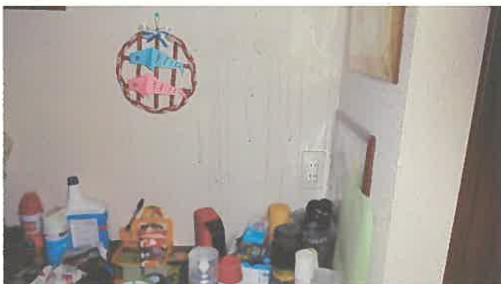
前同（内壁の汚れ）
