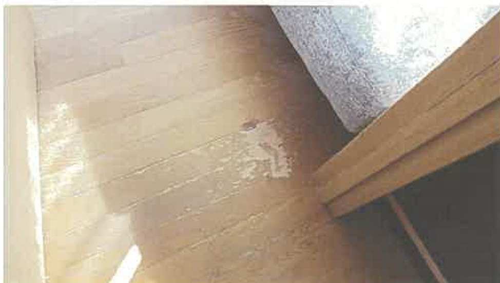
前同 (床板の損傷)
