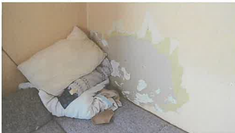
前同 (クロスの損傷)
