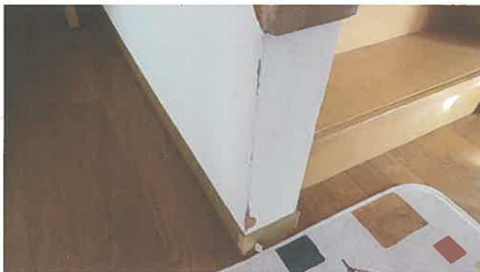
前同 (クロスの損傷)
