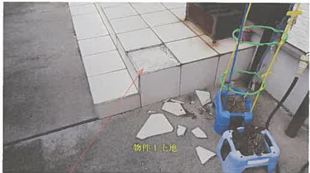
玄関前の平板が破損している
