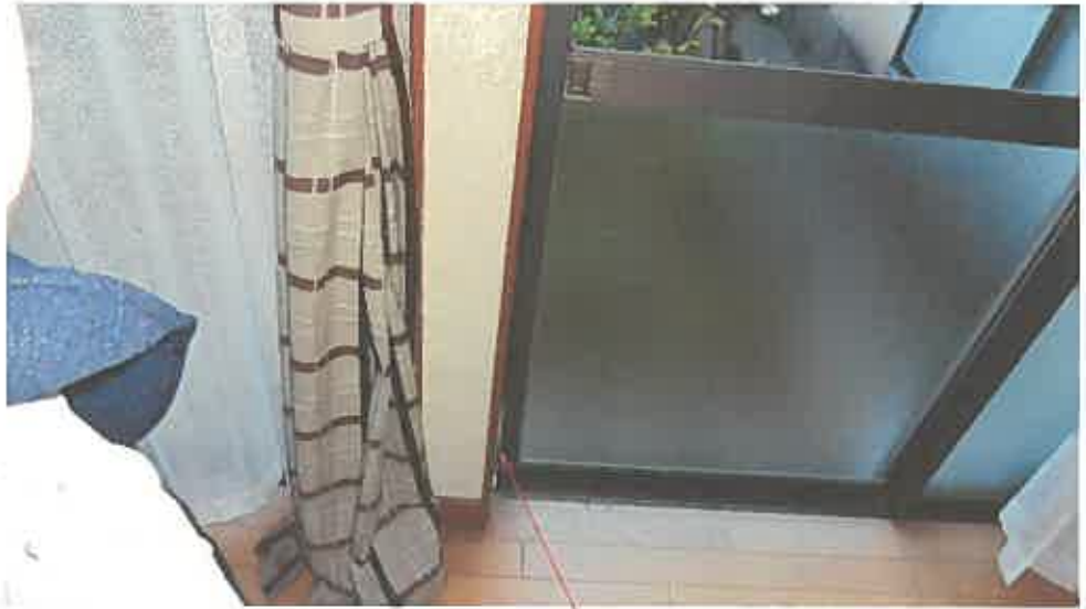
前同 (建具の隙間)
