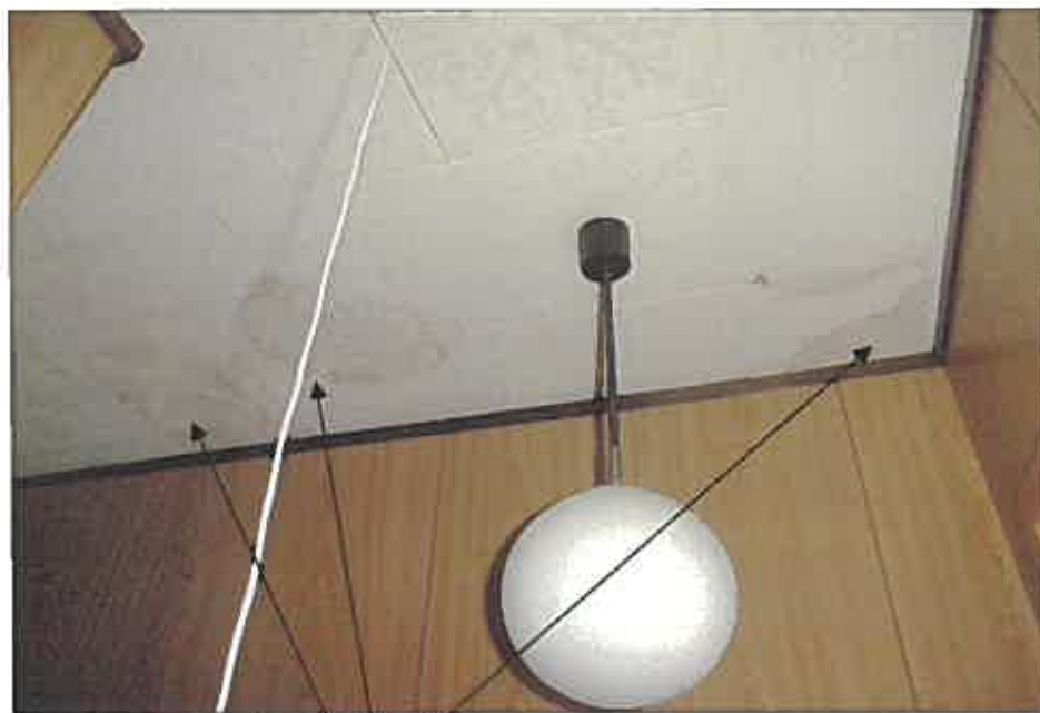
雨漏りの跡 ( 18 枚目)
