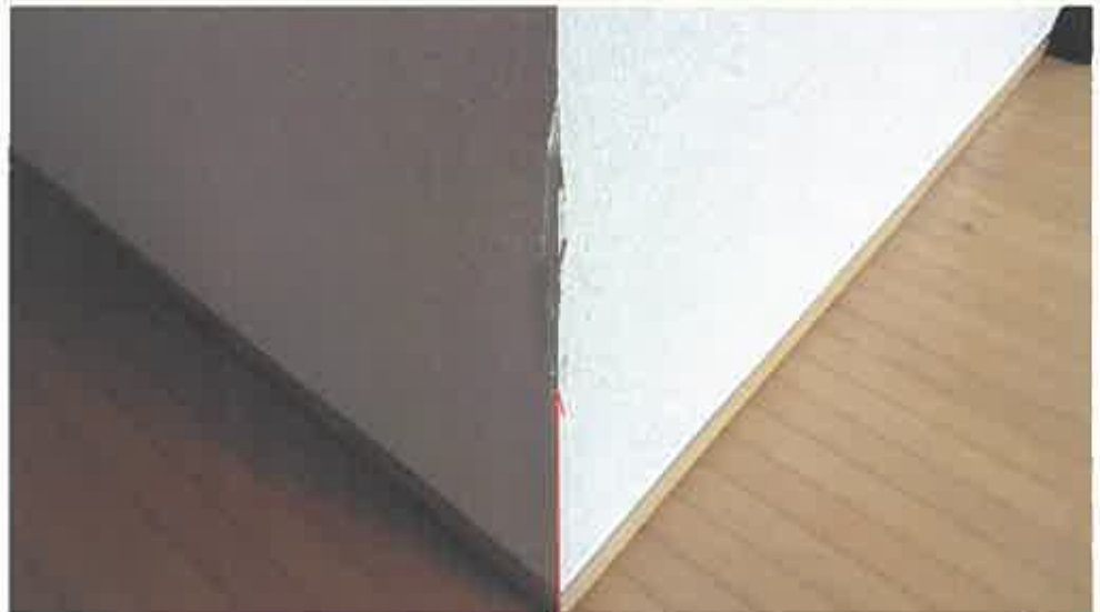
前同 (猫による損傷)
