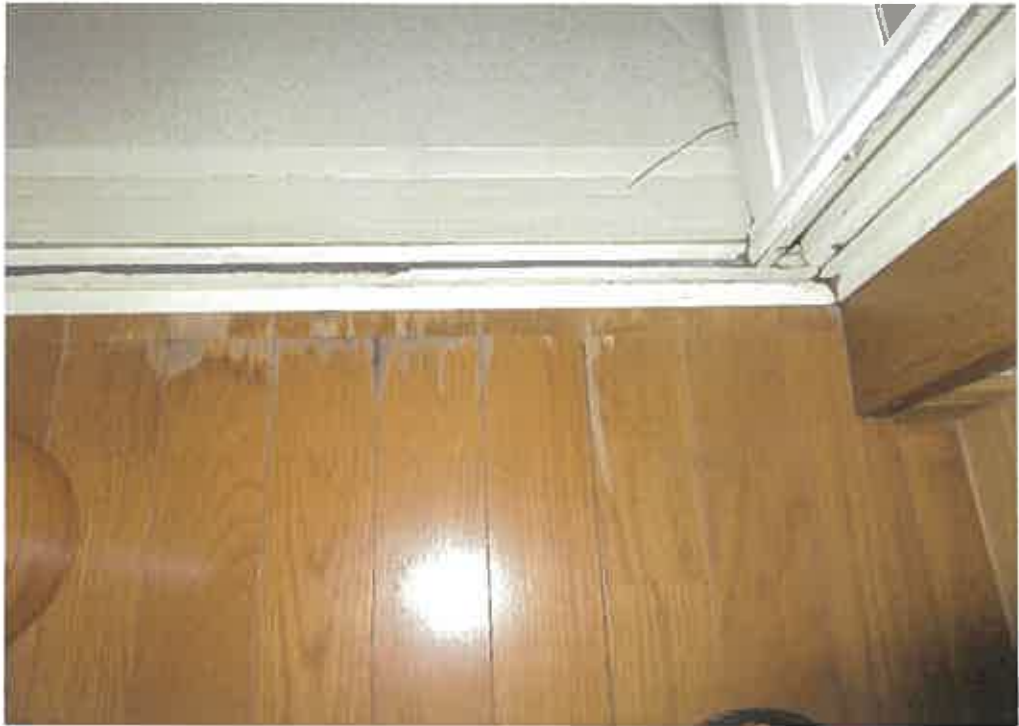
物件3主である建物:洗面室の床の損傷等の状況
