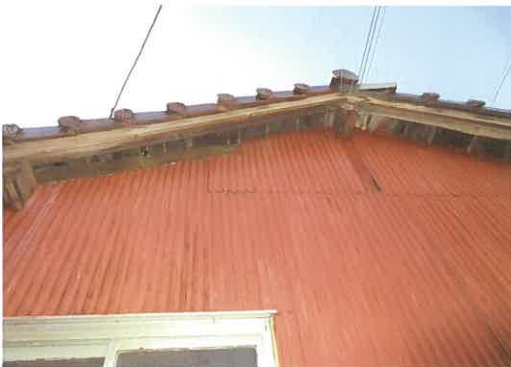
物件3附属建物符号1:トタン波板部分の剥がれ等の状況
