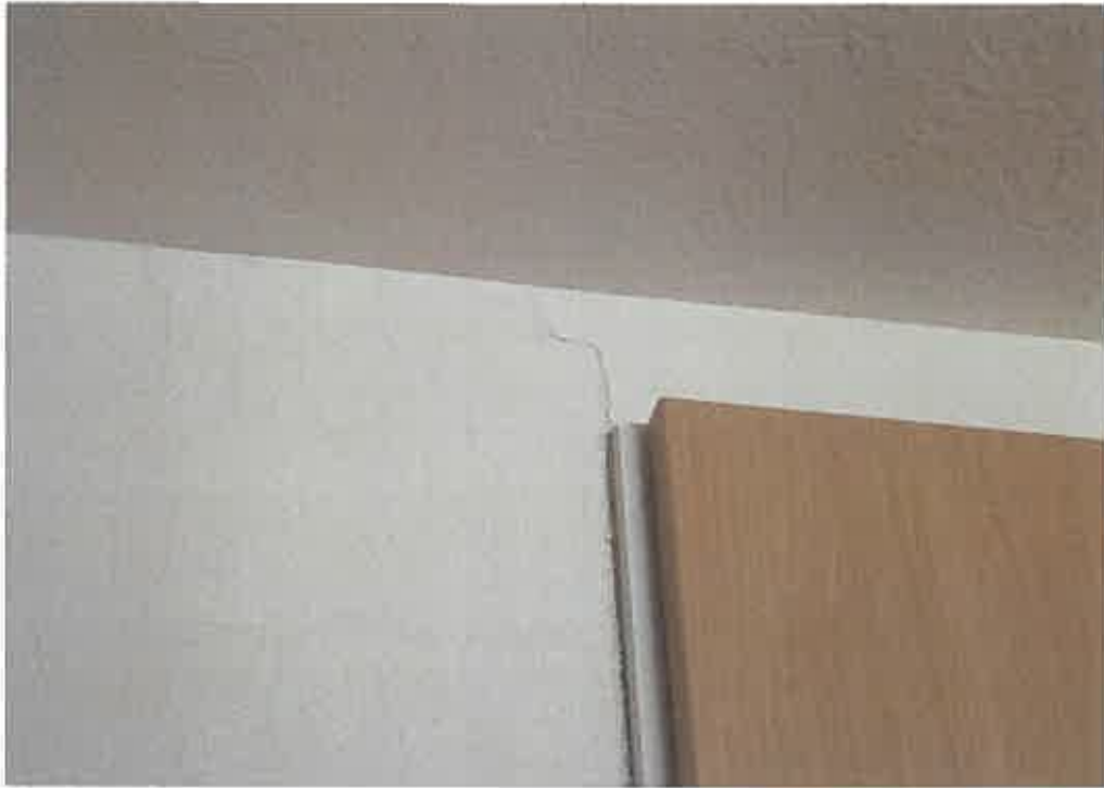
物件2:1階リビングダイニングの内壁クロスのひびの状況
