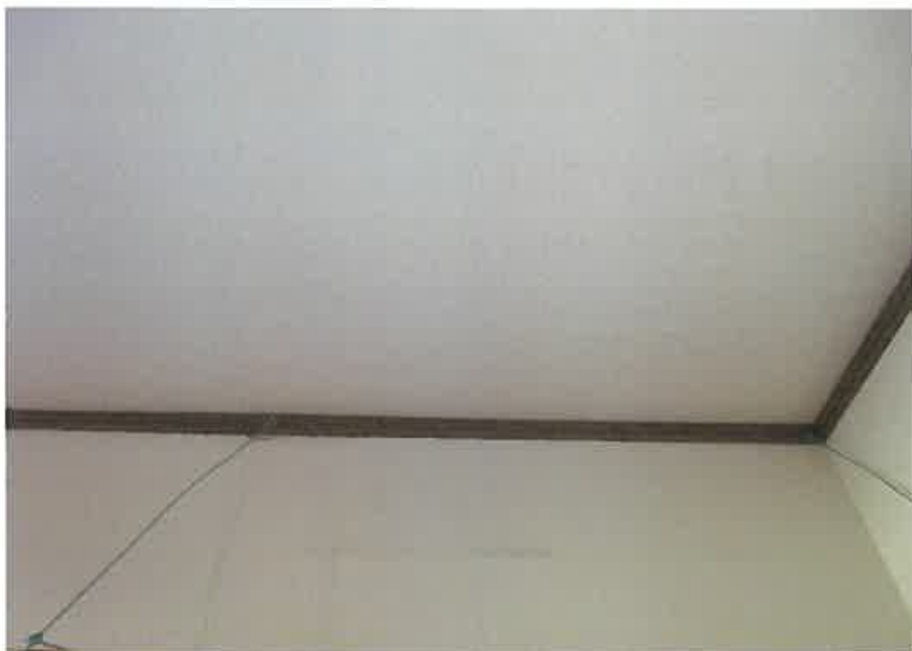
物件3主である建物:洗面室の内壁クロスのひび等の状況
