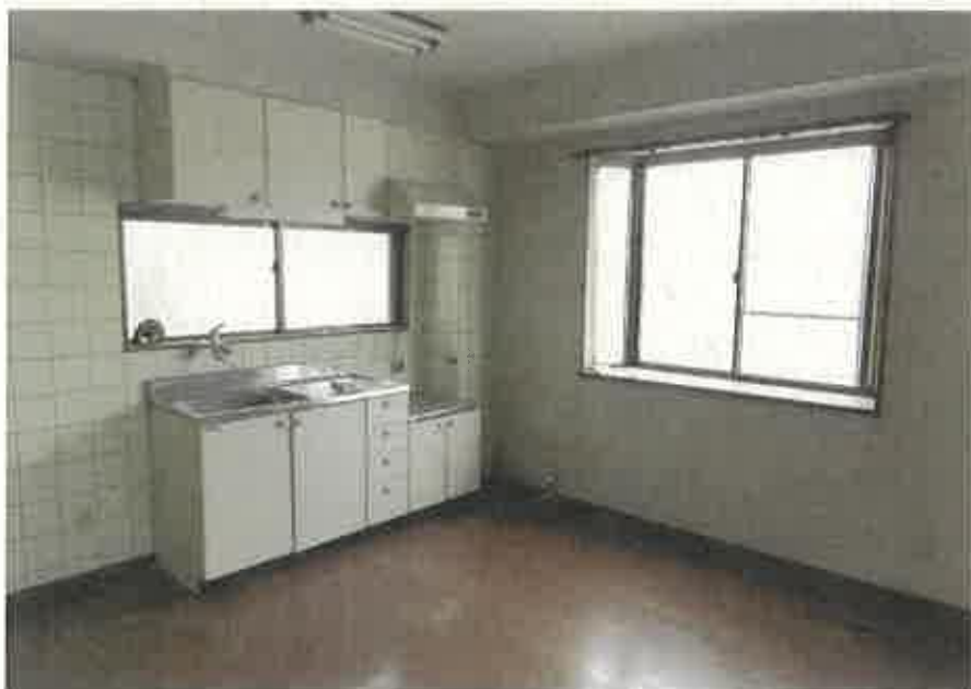
物件3主である建物: 111号室ダイニングキッチン の状況
