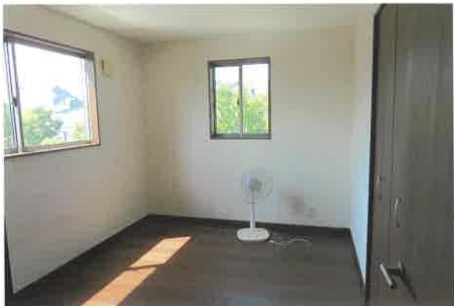
物件2:2階北西側洋室の状況
