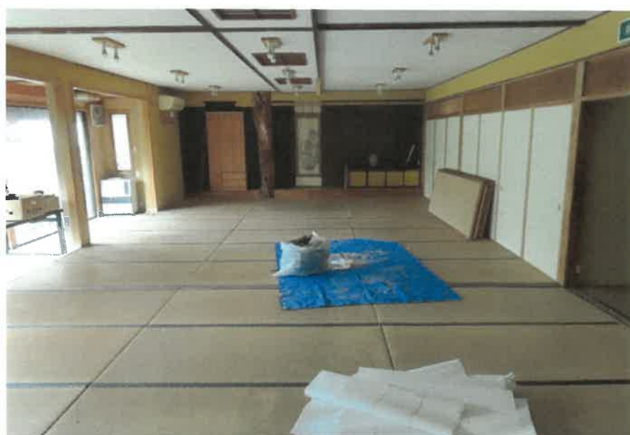
物件3:1階大広間の状況
