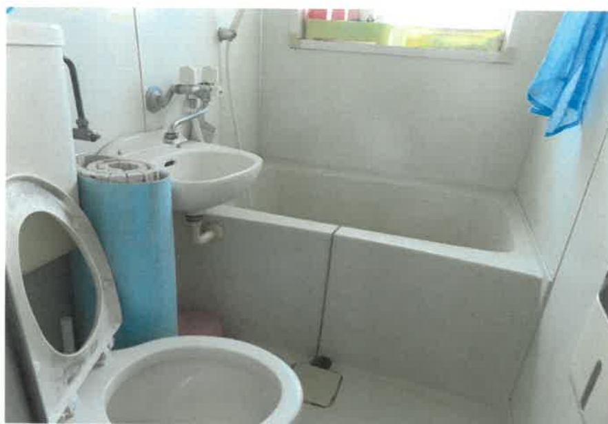
物件3:2階ユニットバスの状況
