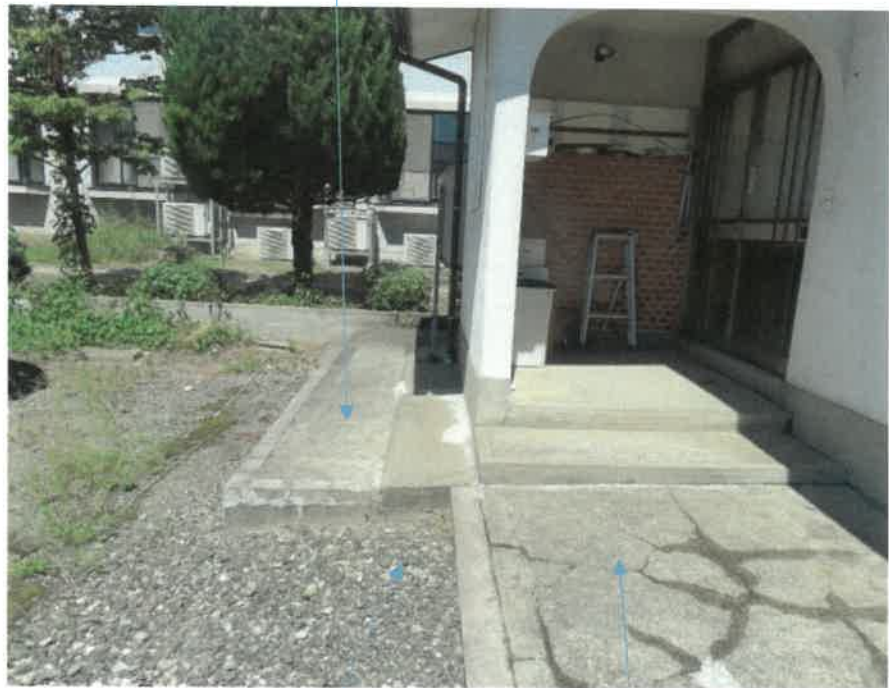
東側隣地上建物の犬走り部分
