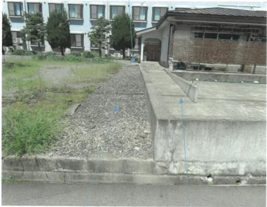
東側隣地上建物の犬走り部分
