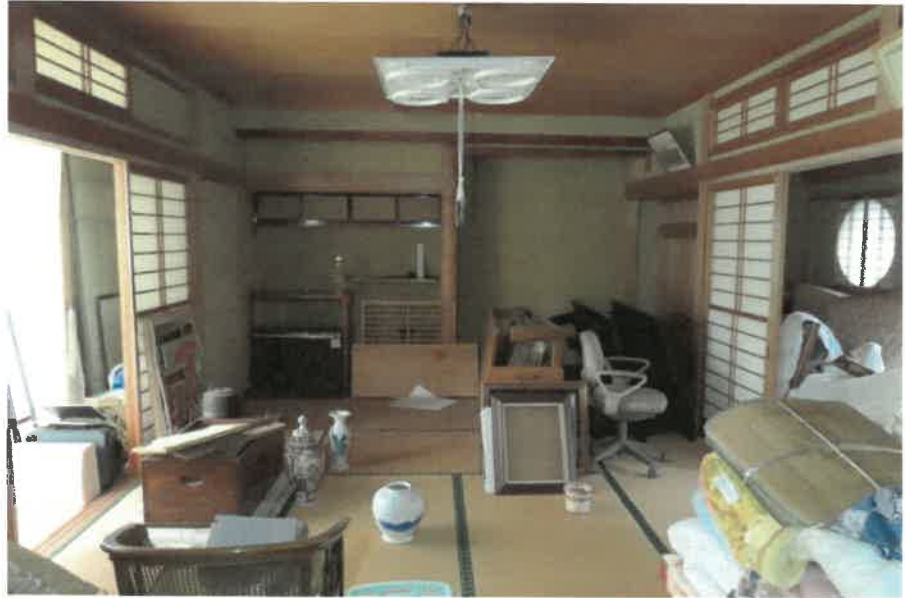
物件3:1階北側和室の状況
