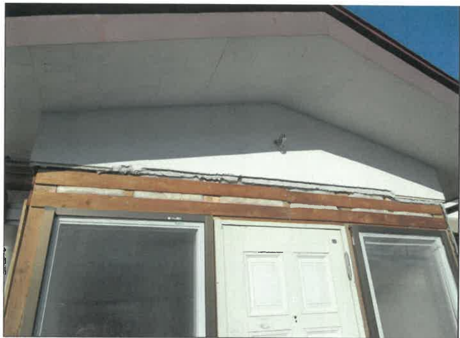
物件2:玄関上部の外壁の剥離
