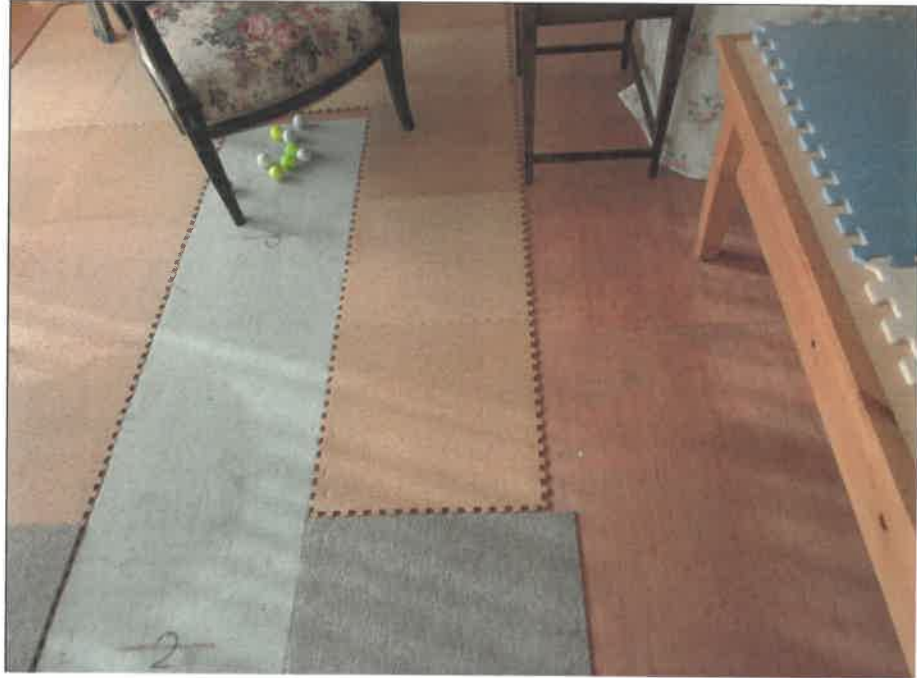
物件2:1階リビングルームの床の状況
