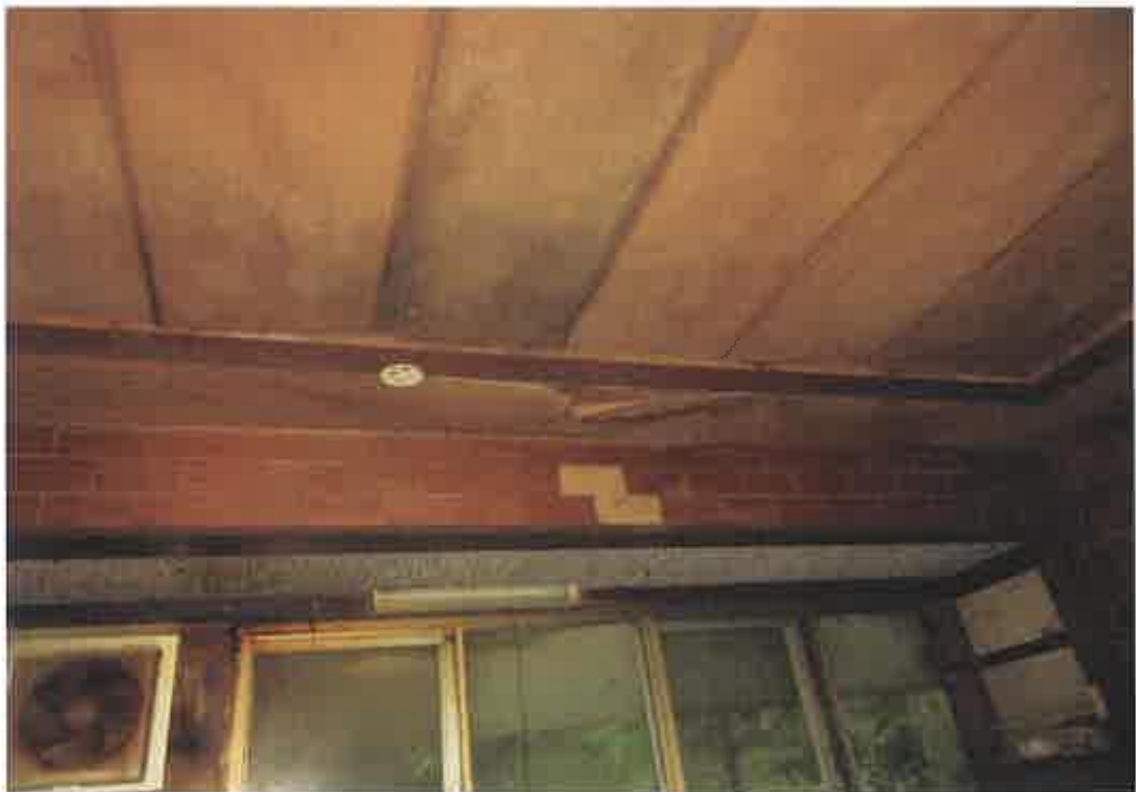
物件2主である建物のDKの天井の損傷等の状況
