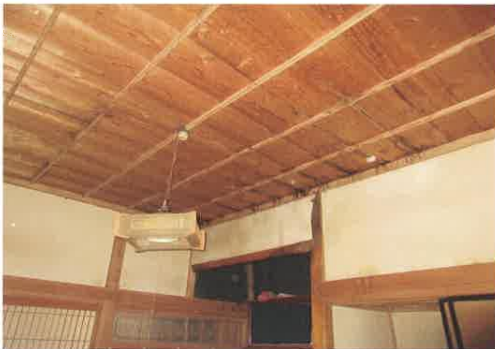
物件2主である建物和室1の天井のしみ等の状況
