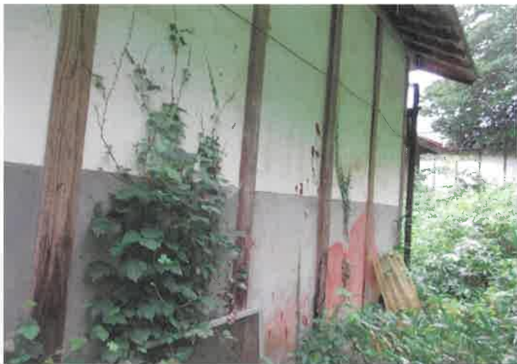
物件2主である建物の外壁の汚損等の状況
