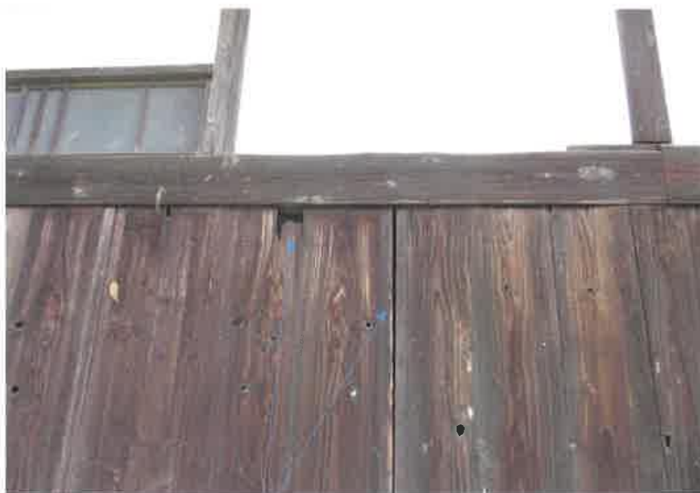
物件2主である建物の板張りの壁部分の損傷や隙間
