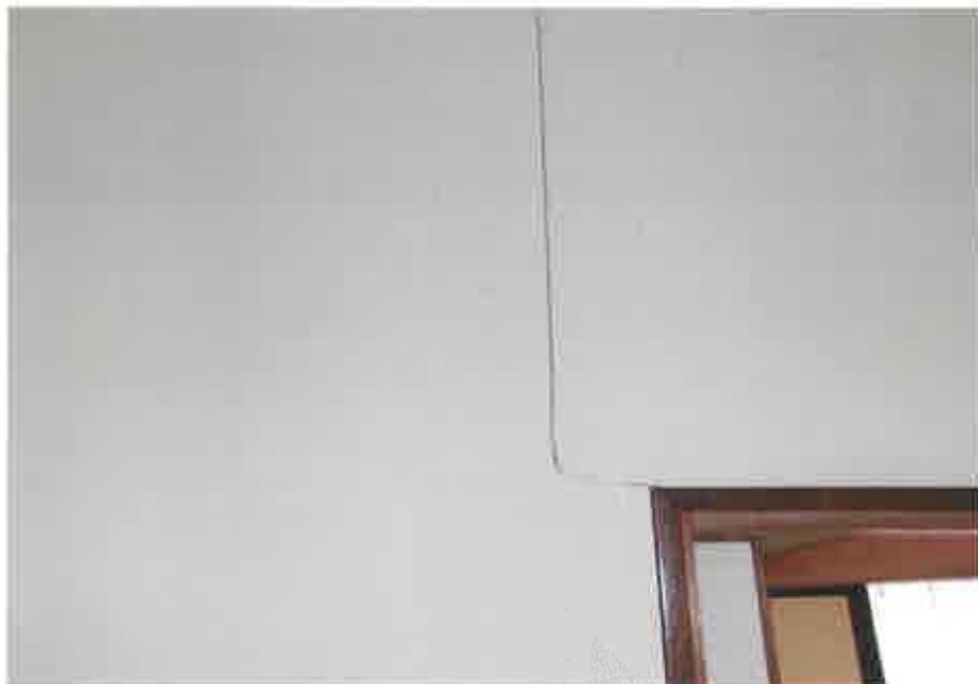
物件3:1階ホール西側和室出入口壁上部の状況
