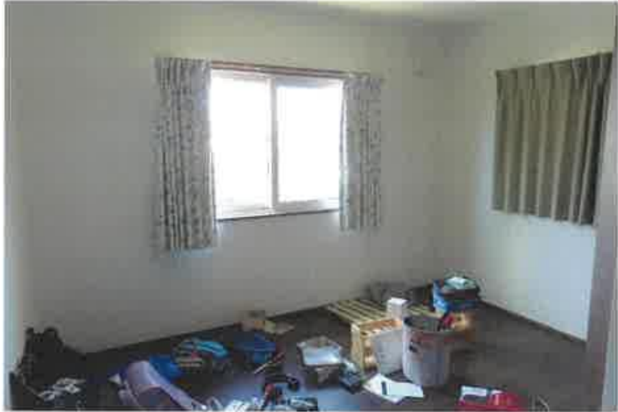
物件2:2階西側洋室の状況
