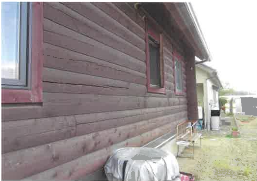
物件3:外壁のひび等の状況
