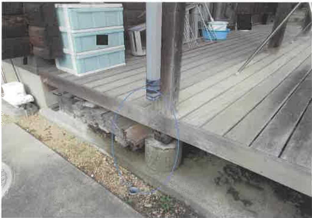
物件3:雨樋の縦樋部分の一部が外れている状況
