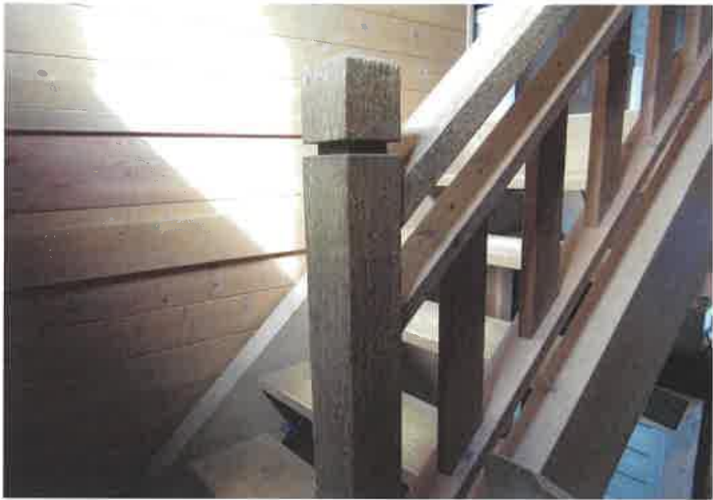
物件3:階段の親柱や手すりの猫の爪とぎの 跡等の状況
