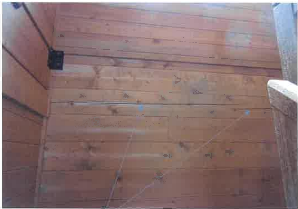
物件3:階段踊り場の壁のひび
