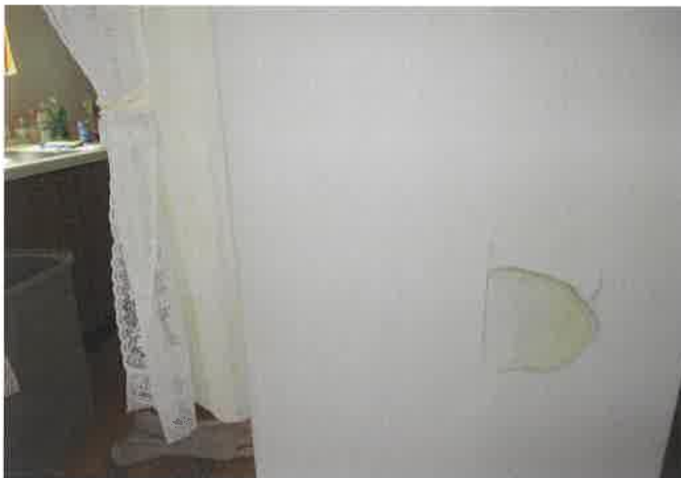
物件2:1階LDの内壁の損傷等の状況
