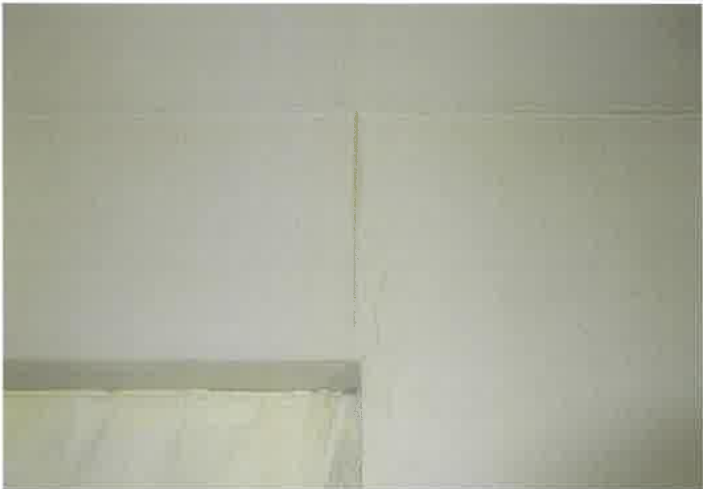
物件2:1階LDの内壁クロスのひび等の状況
