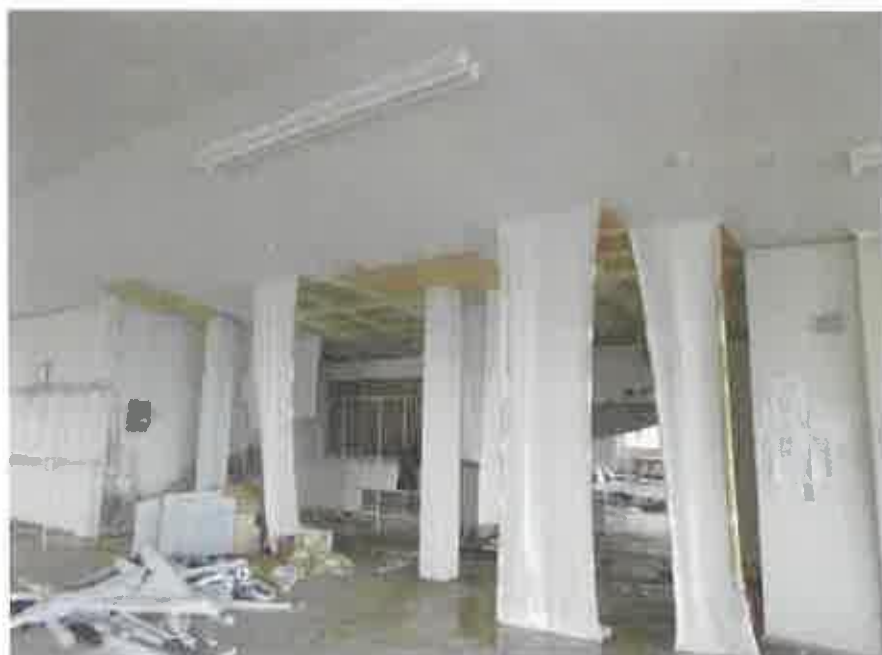
No. 16 物件4:主である建物1階東側工場の状況 (雨漏りで垂れ下がった天井クロス)
