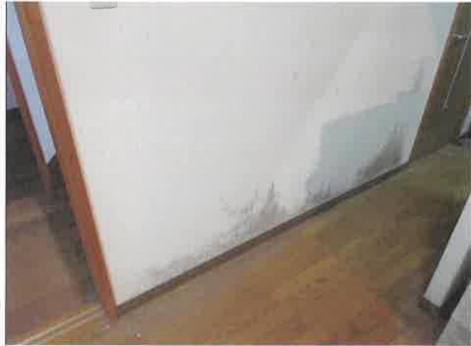
物件3:1階東側食堂の壁クロス
