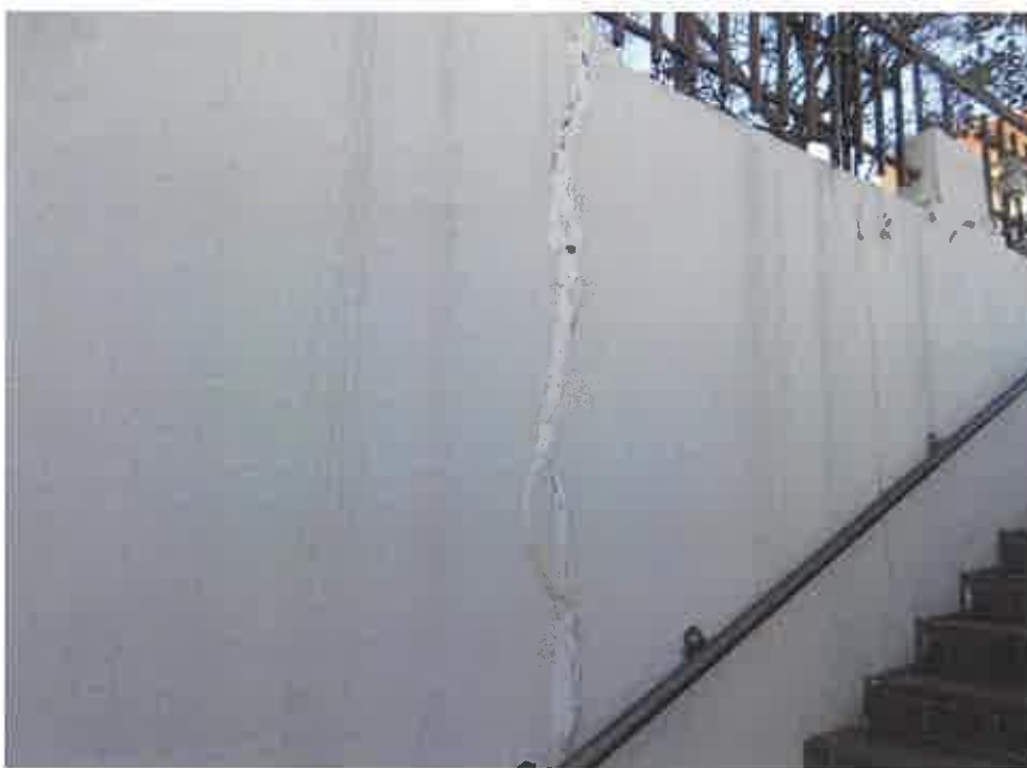
南東側階段のひびの状況
