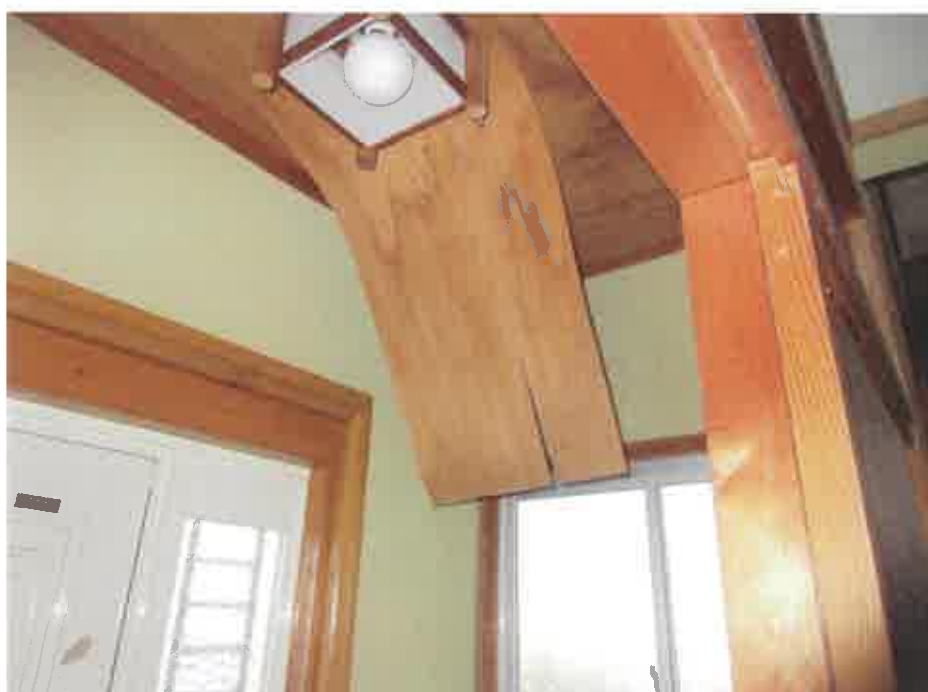
主である建物(別棟)2階の玄関の天井の破損状況
