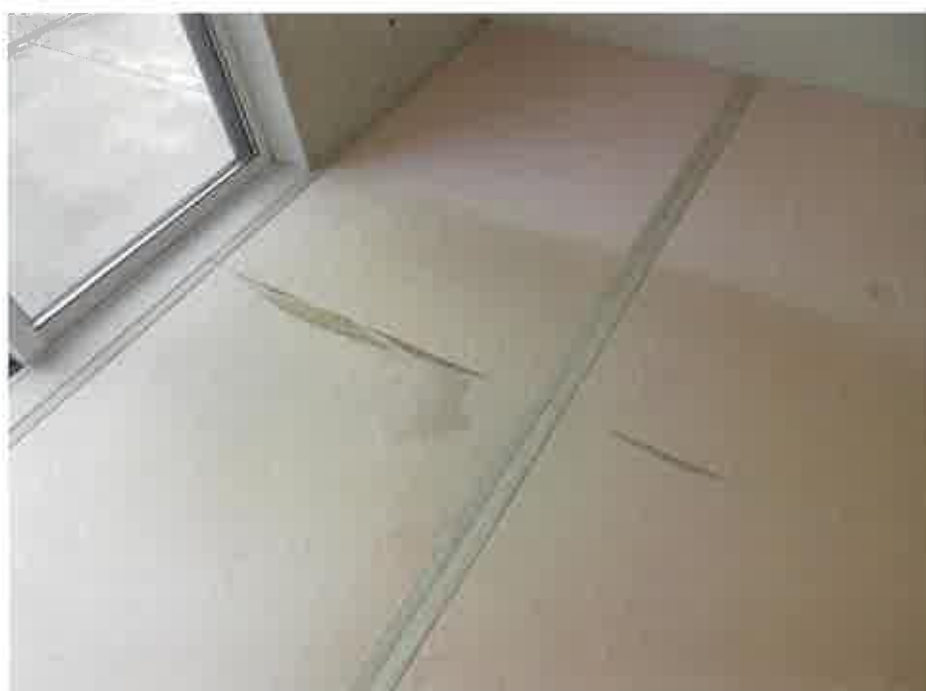
物件2:1階和室の畳の損傷状況
