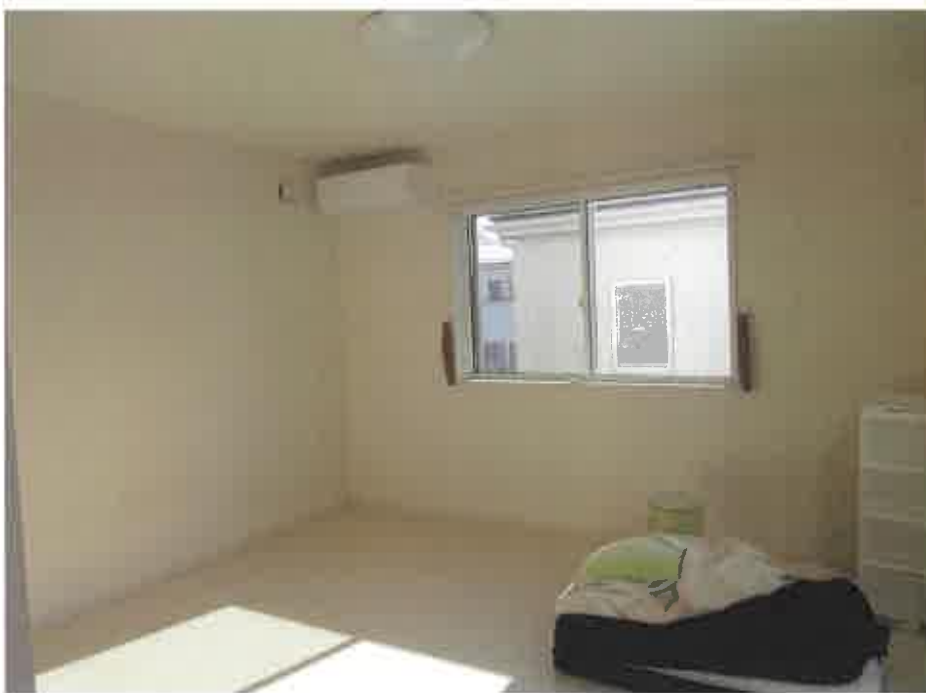
物件2:2階南側洋室の状況
