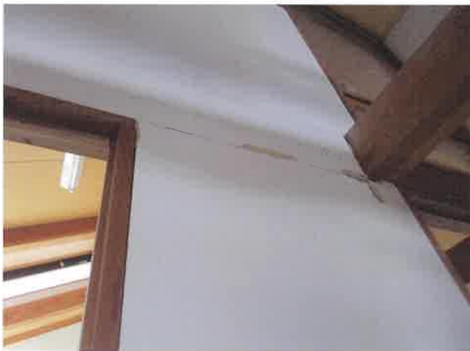
物件2:3階東棟の内壁のひび等の状況
