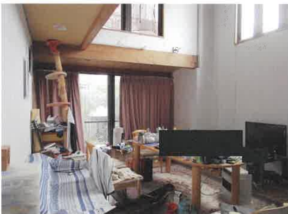
物件2:2階西側洋室の状況
