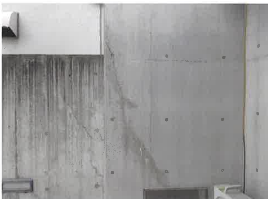
物件2:外壁のひびの状況
