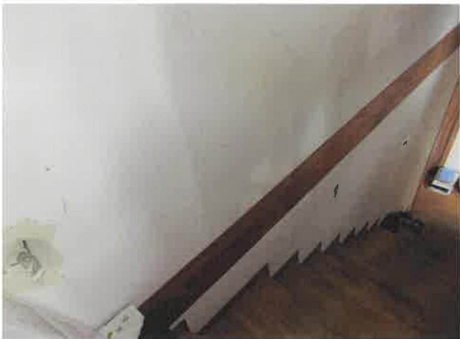
物件2:西棟の2階から3階に上がる階段の内壁の 損傷等
