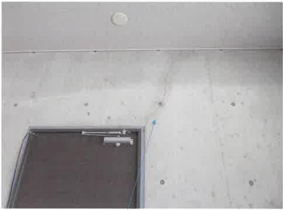
物件2:1階エントランスホール南側内壁のひび
