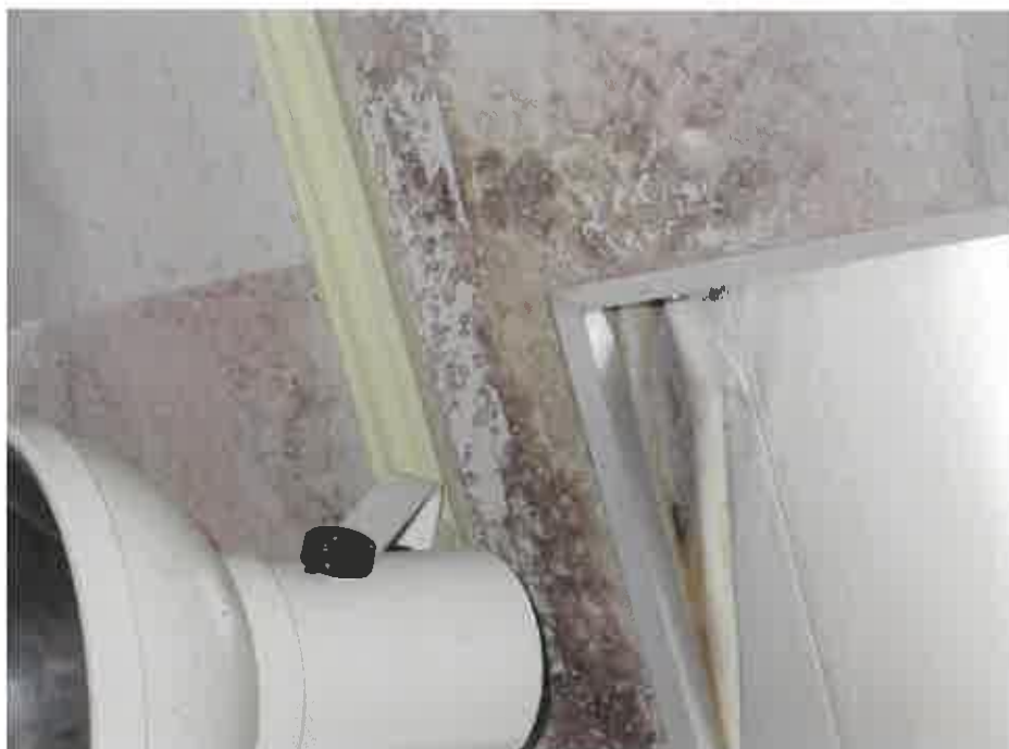
物件2:1階の明り取り窓と天井部分の損傷等の状況
