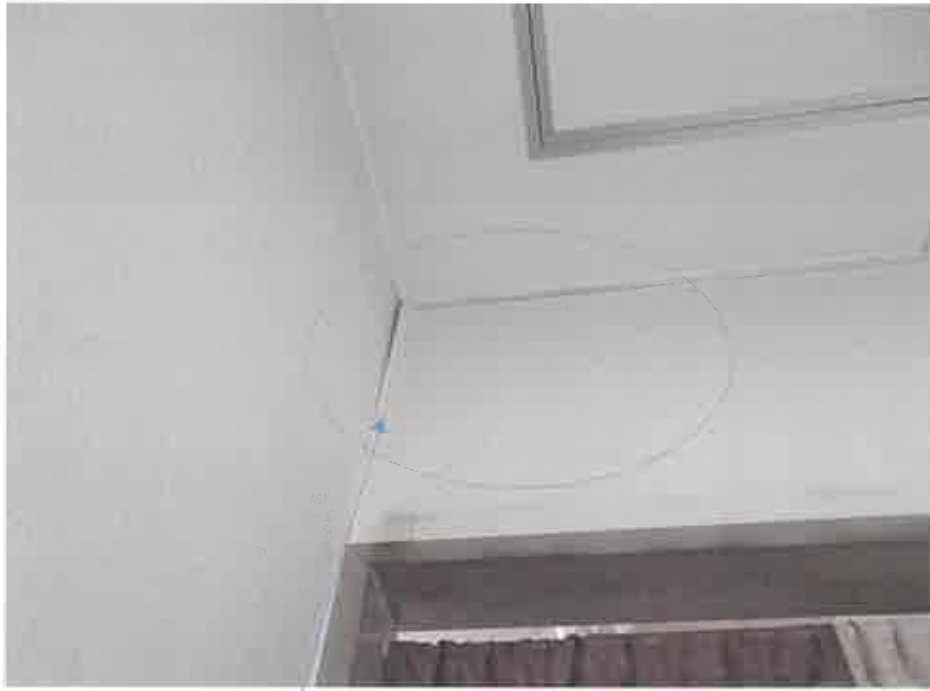
物件3:1階給湯室の内壁の剥がれ等
