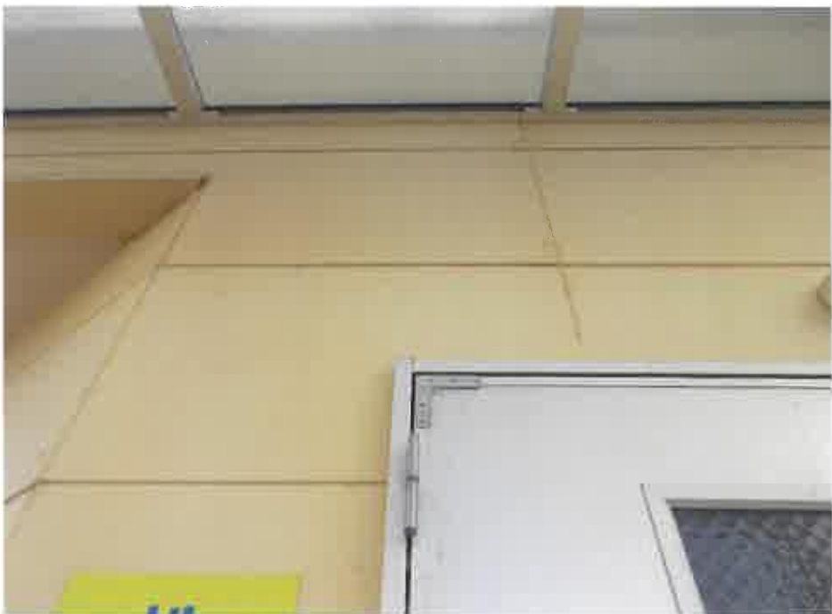
物件3:外壁のひびの状況
