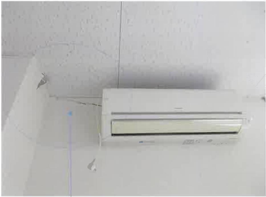
物件3:2階東側事務室の内壁のひび等の状況
