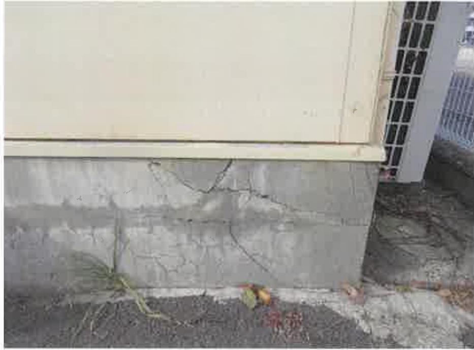
物件3:基礎部分のひびの状況
