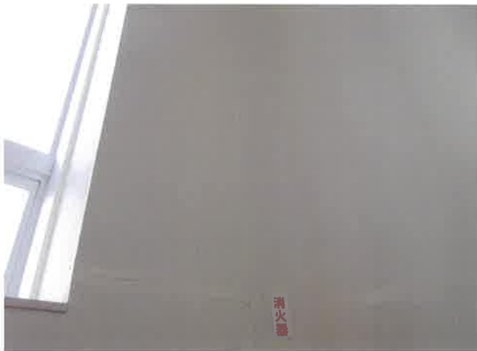
物件3:階段の内壁のひび等の状況
