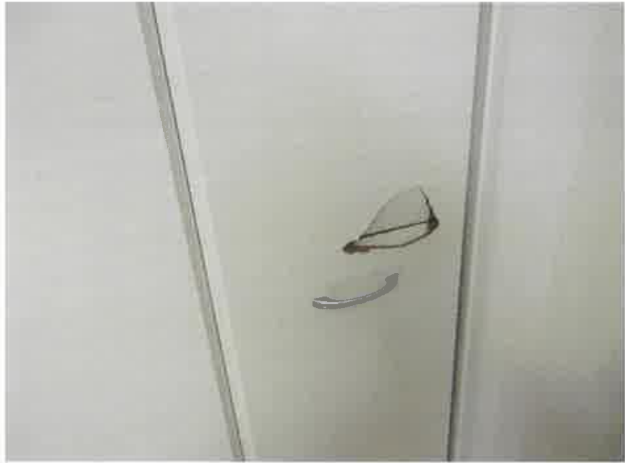
物件2:2階西側洋室クローゼット扉の破損状況 No. 11
