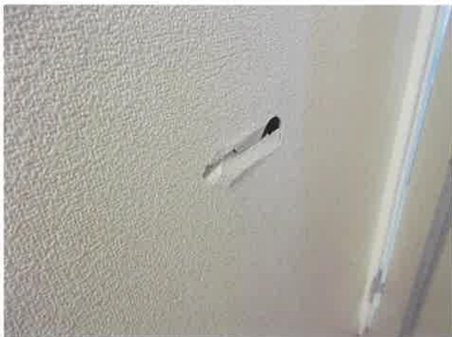
物件2:1階廊下壁面の破損状況 No. 12
