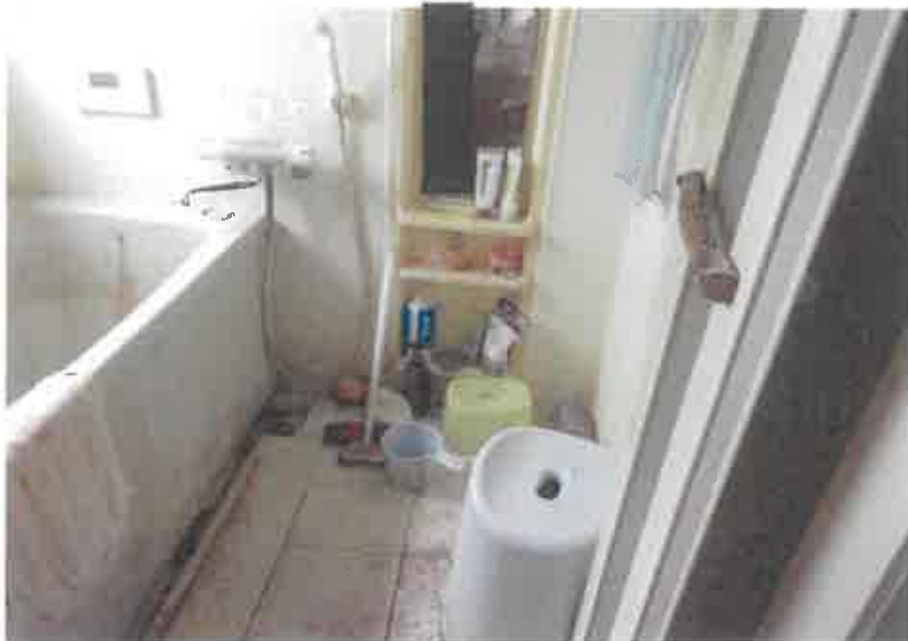
物件2主である建物1階浴室の状況 No. 10
