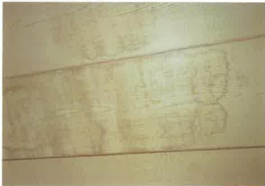
物件2主である建物1階西側和室の天井のシミの状況 No. 8
