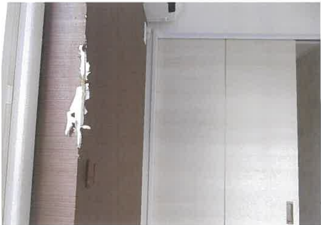
物件3:2階西側洋間の内壁クロスの損傷等の状況
