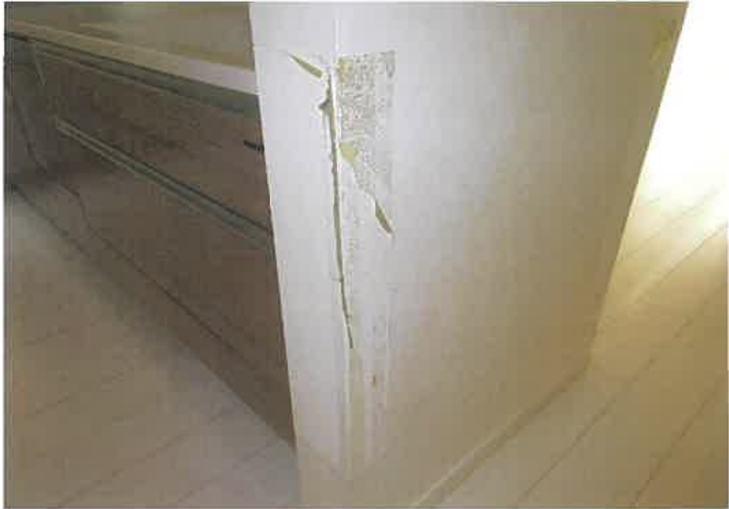
物件3:1階台所の内壁クロスの損傷等の状況
