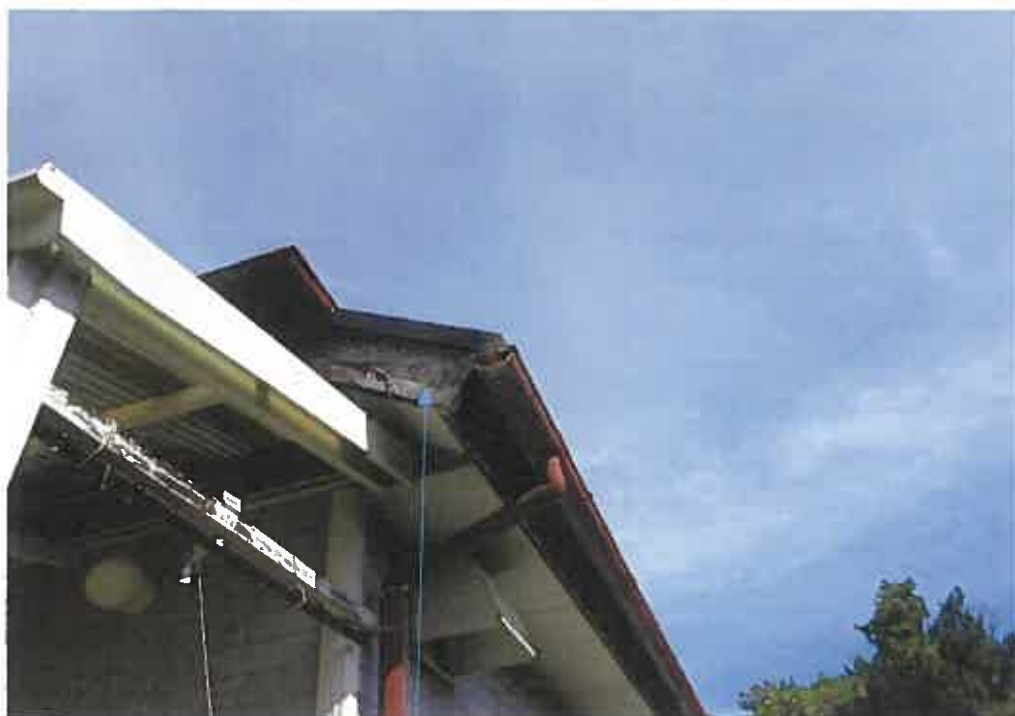
物件2:1階けらば部分の塗装の剥がれ等
