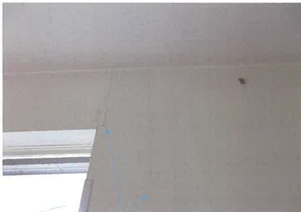
物件2:1階ホールの内壁クロスのひび
