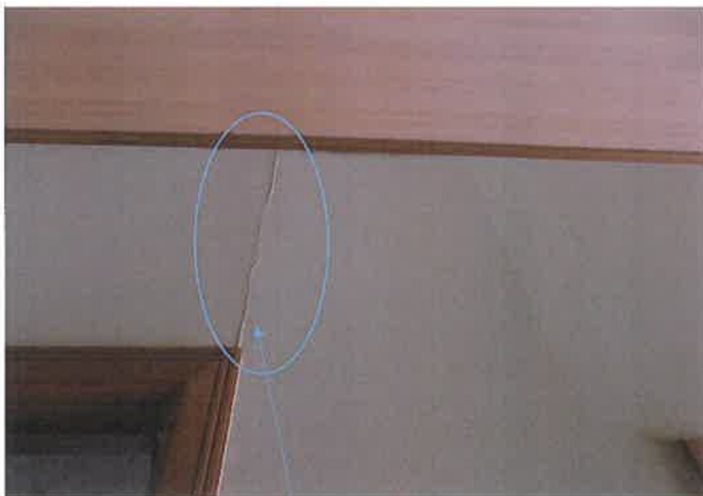
物件2主である建物:1階廊下の内壁のひび
