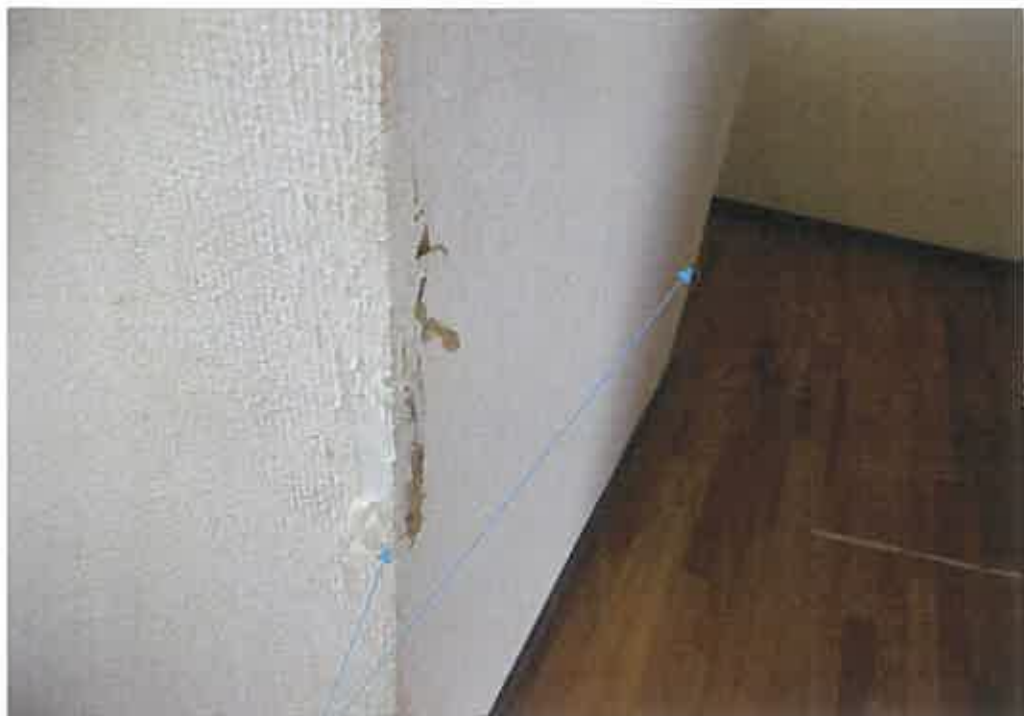
物件4:2階ホールの猫の爪とぎによる損傷等
