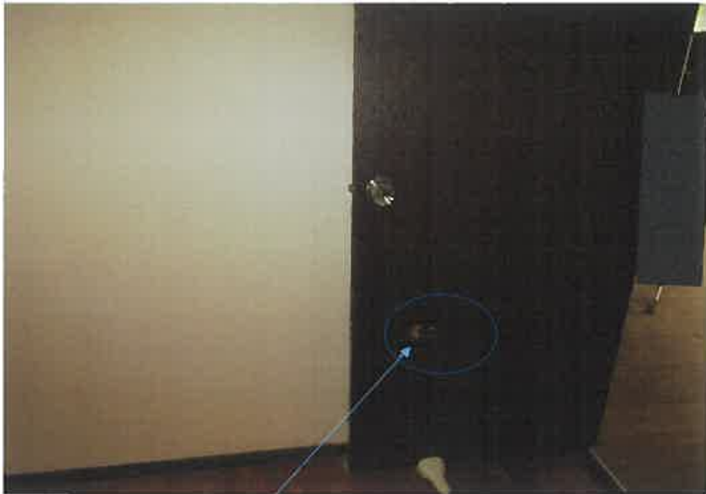
物件4:2階東側洋間のドアの損傷
