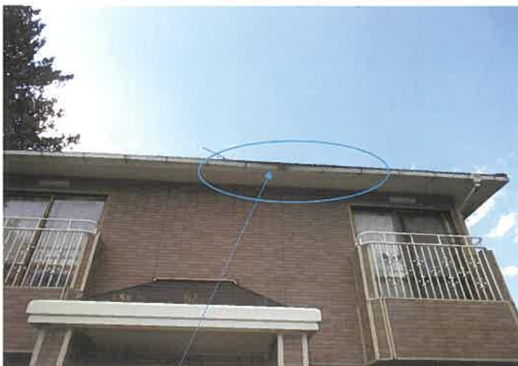
物件4: 雨樋のゆがみ等
