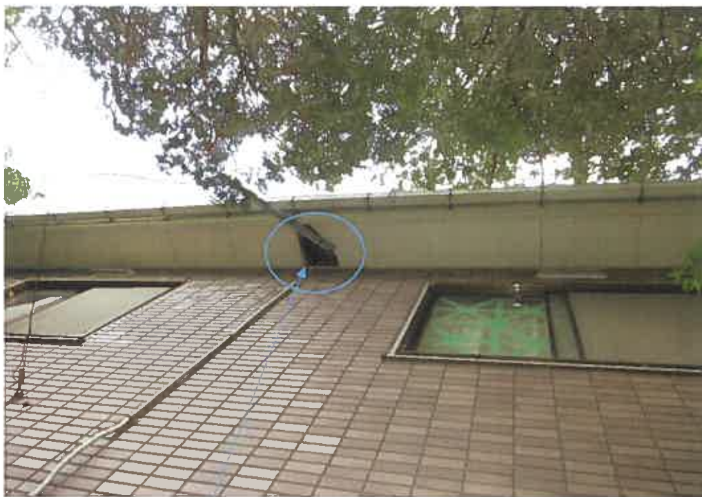
物件4: 西側軒天の損傷
