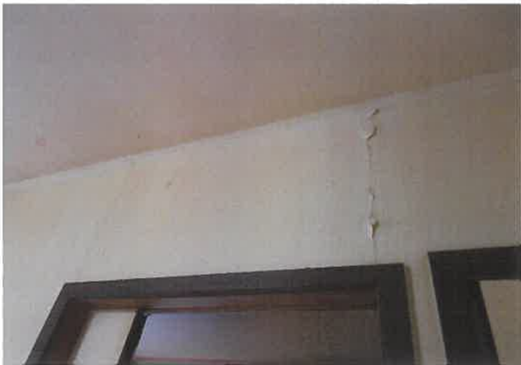
物件4:1階廊下の内壁のひび等の状況
