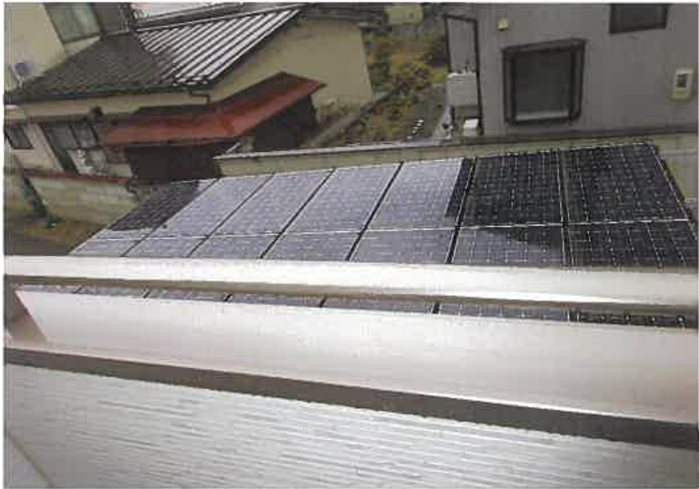
物件2の2階洋室Bのバルコニーから見た、カーポートに付合しているソーラーパネルの状況
