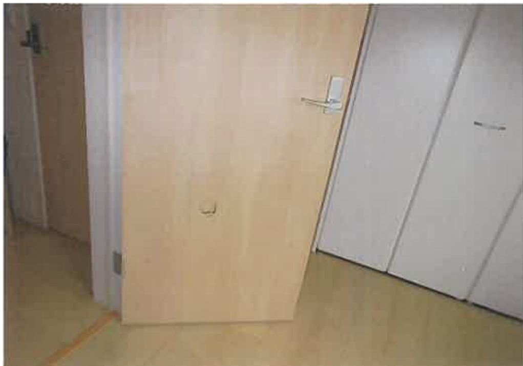
物件2:2階洋室Aのドアの損傷の状況
