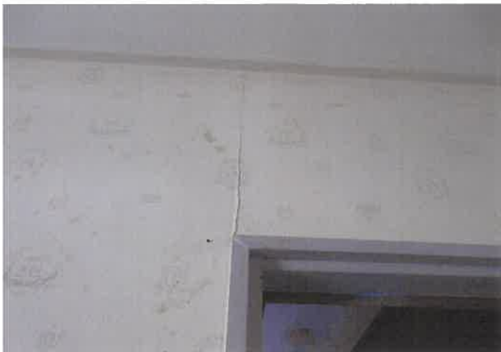
物件2:2階洋室の内壁クロスのひびの状況
