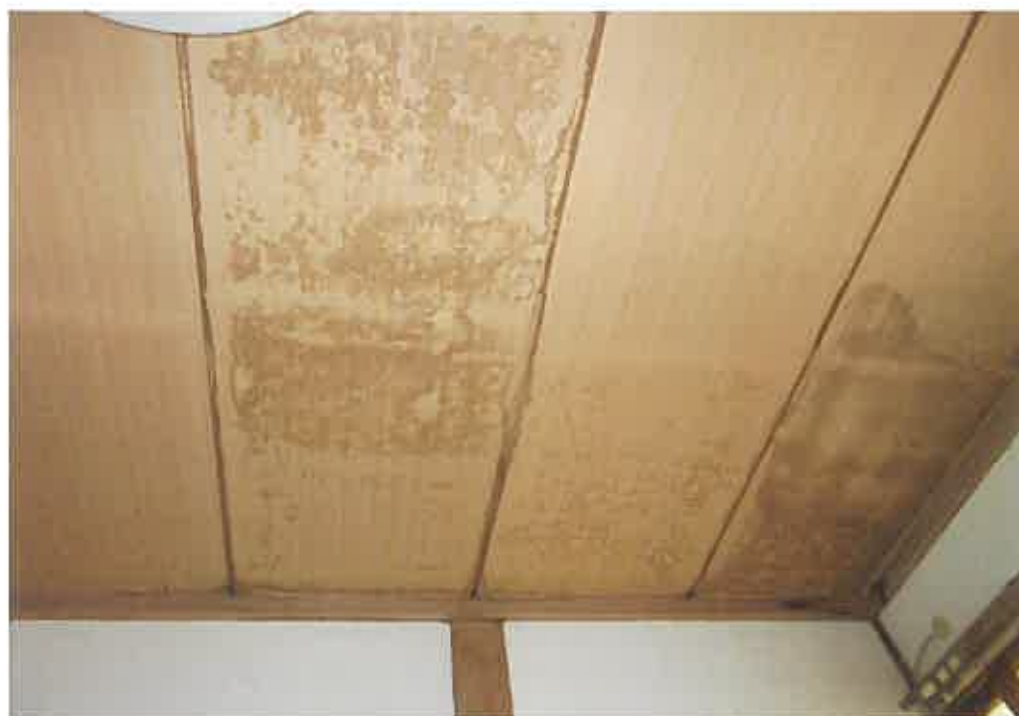
物件2:2階西側和室の天井のしみの状況
