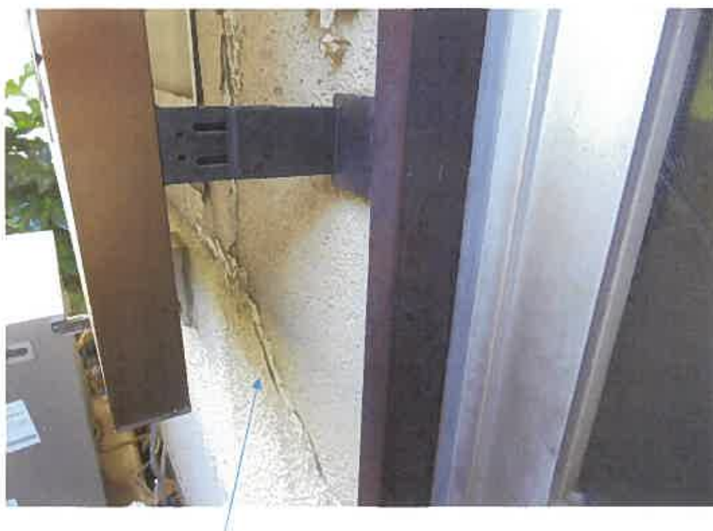
物件2:北側外壁のひびの状況
