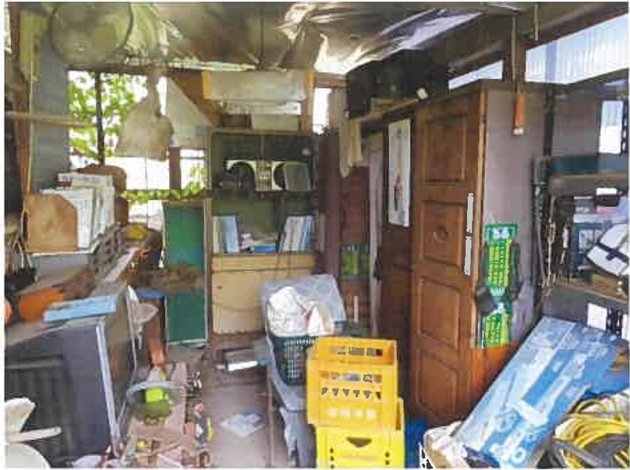
物件12未登記附属建物1:1階北東側物置の状況
