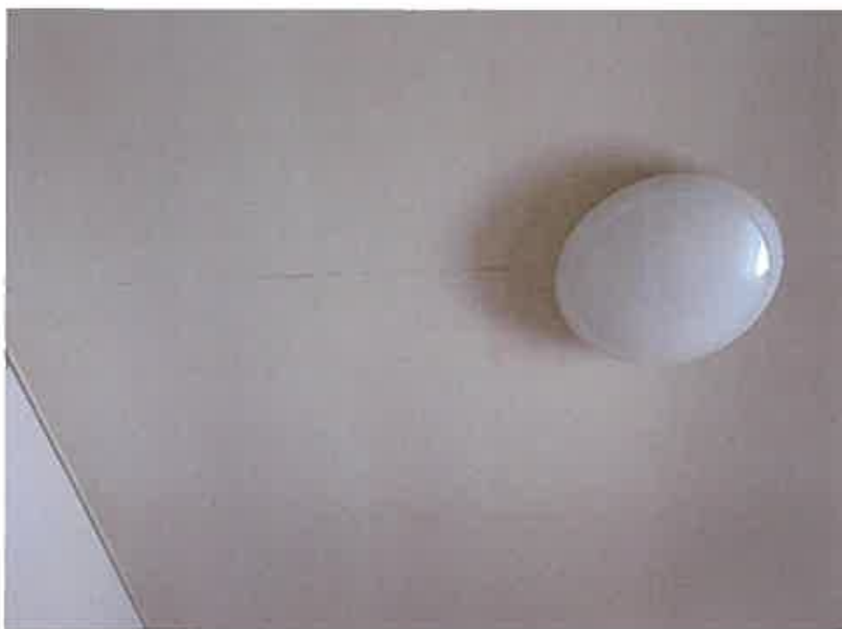
物件2:2階東側洋室の天井クロスのひび等の状況 No. 11
