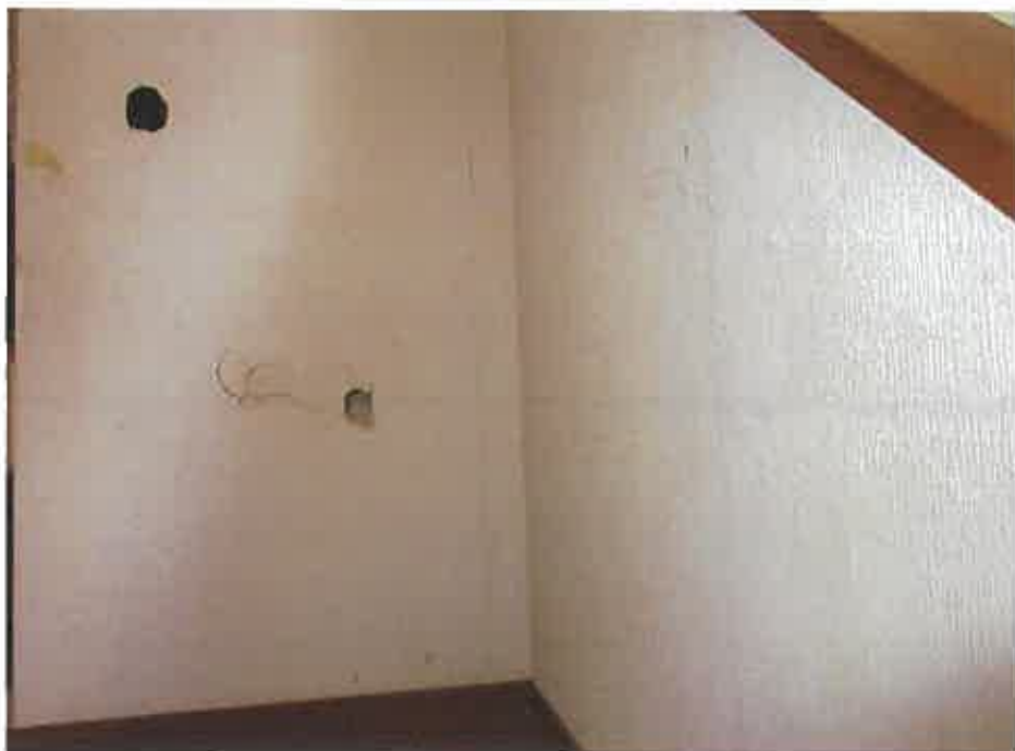
物件2:2階の階段側の内壁の穴等の状況
