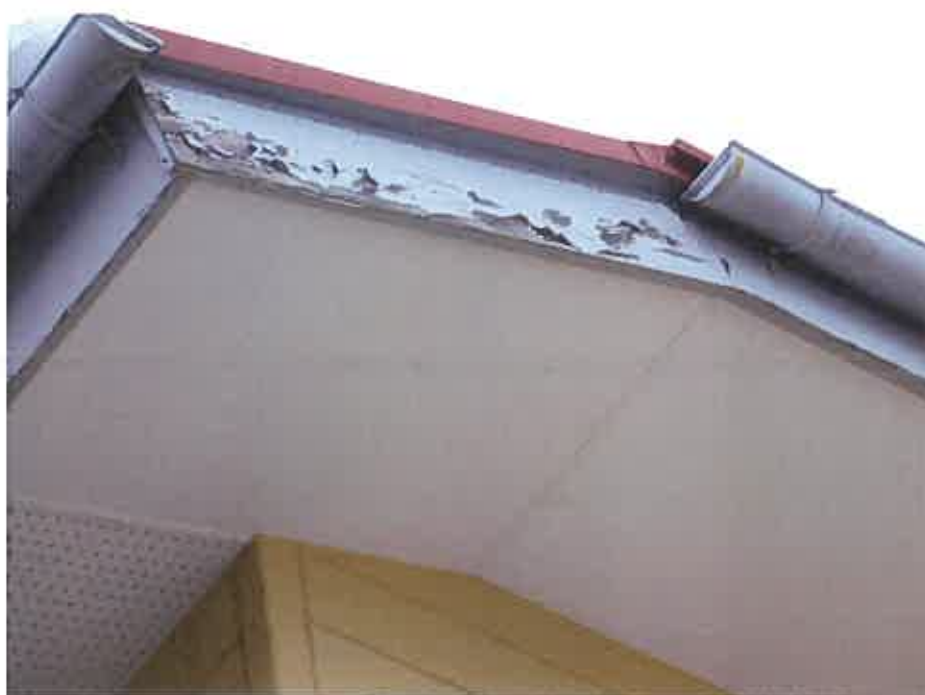
物件2:2階屋根のけらば部分の剥がれ等の状況 No. 12
